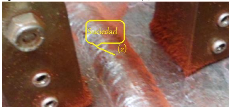
Figura 43 TOMA MT -PS No. 3 Punto (2)
