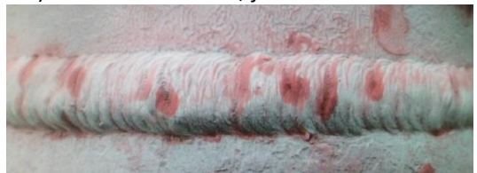
d) Falta de Fusión.
