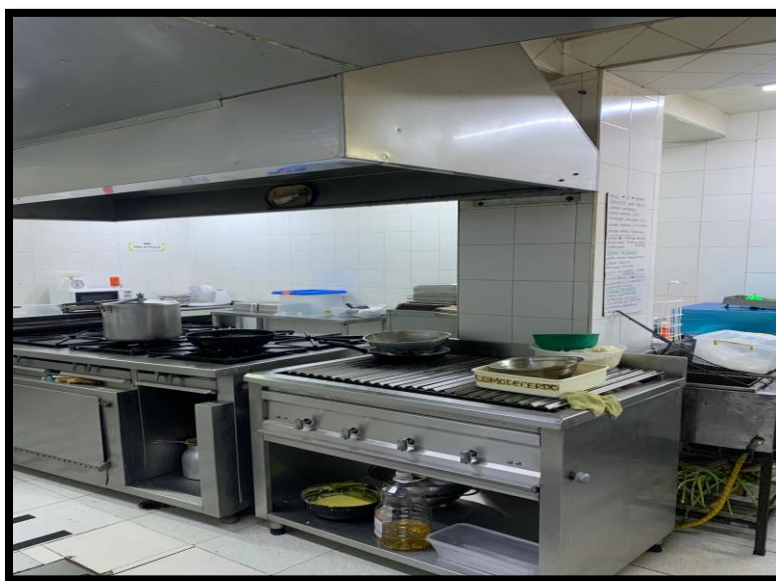
Figura 6. Área de preparación y cocción de alimentos restaurante Sazonarte Sede Bucaramanga
