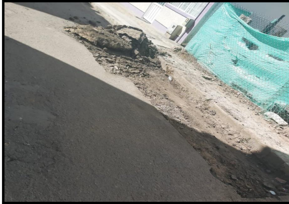
Figura 28. Patología vial ya recortada.
