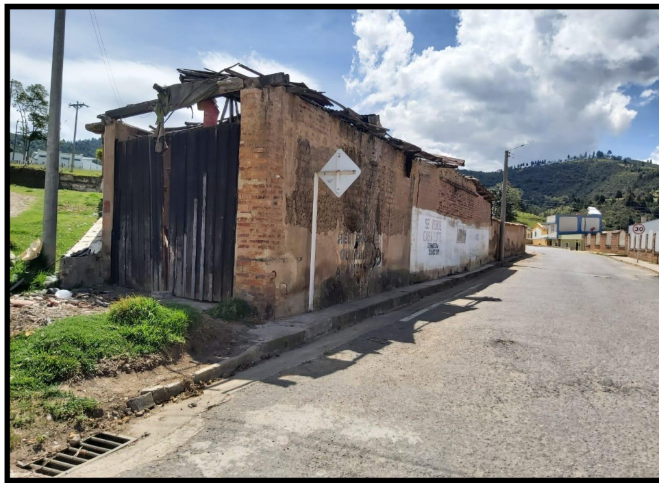
Figura 50. Vivienda con mala conservación de la estructura.
