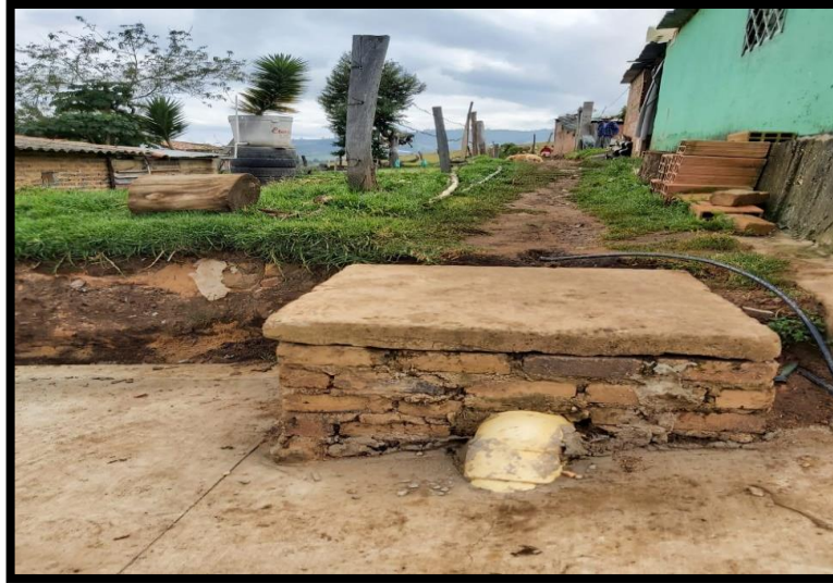
Figura 51. Caja de inspección.
