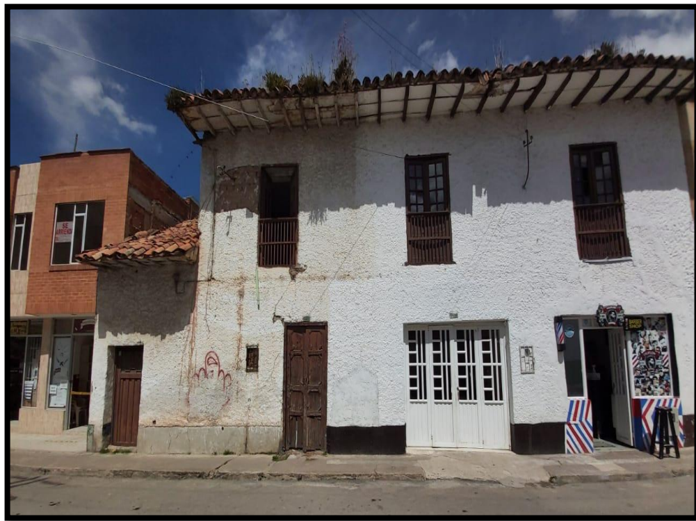
Figura 32. Vivienda en amenaza de ruina.
