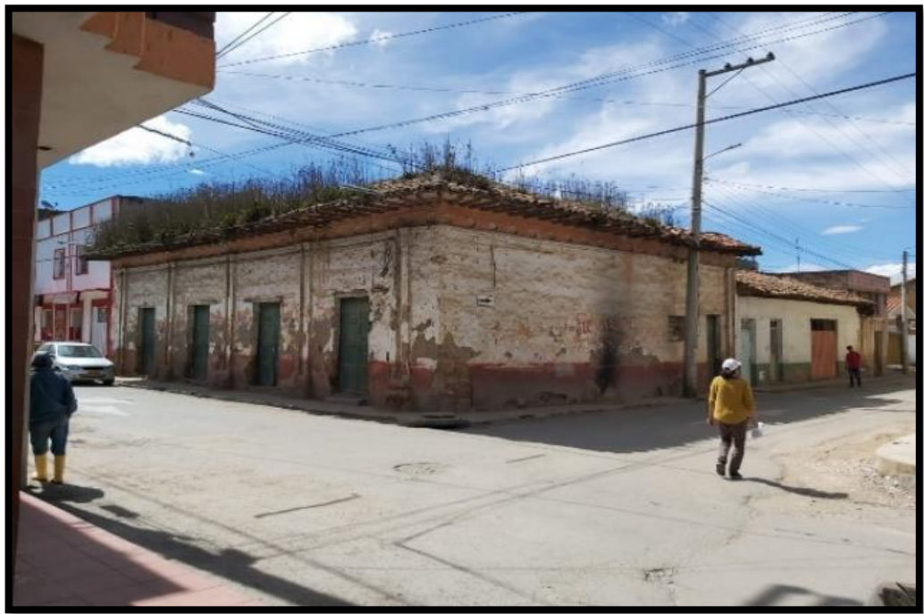
Figura 34. Propiedad con mala conservación de la estructura.
