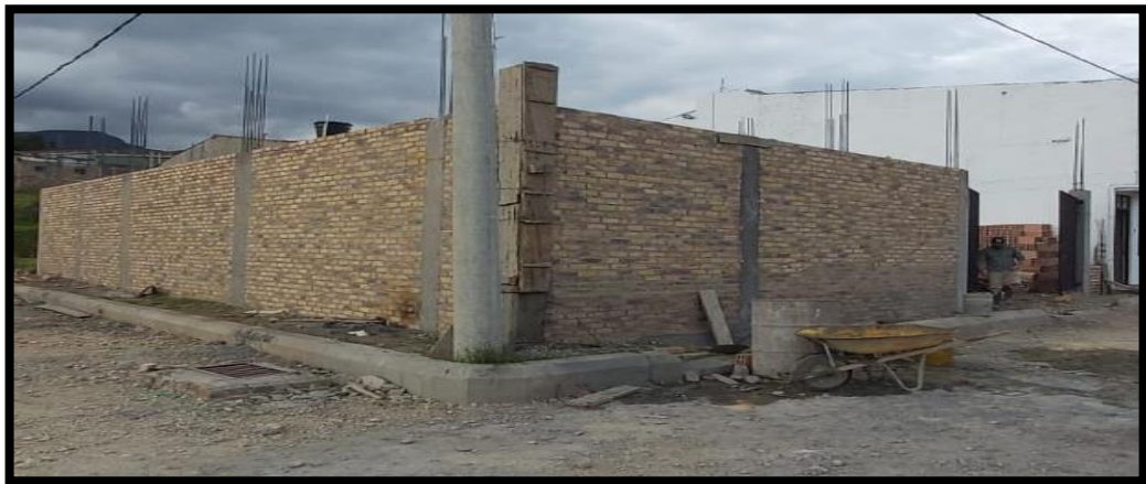
Figura 35. Construcción intervenida por falta de licencia de construcción en el Barrio Villa Republicana.
