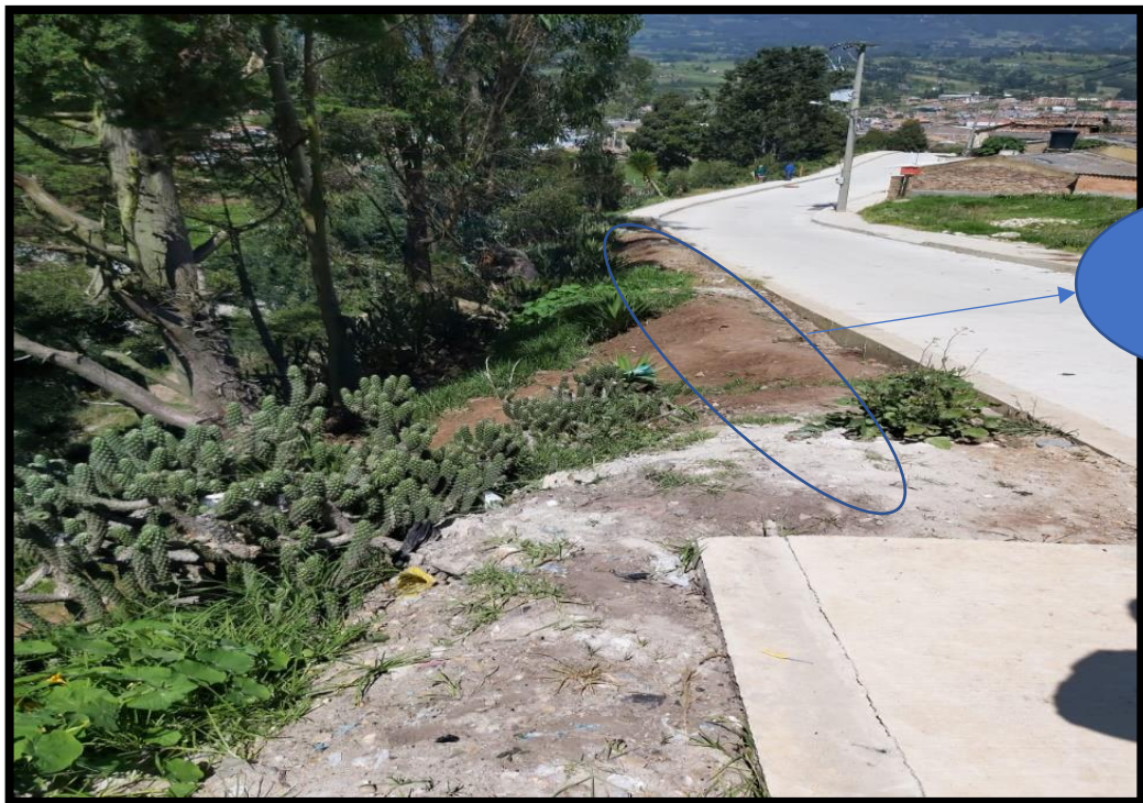
Figura 11. No se pudo realizar el bordillo debido a la presencia del talud.
