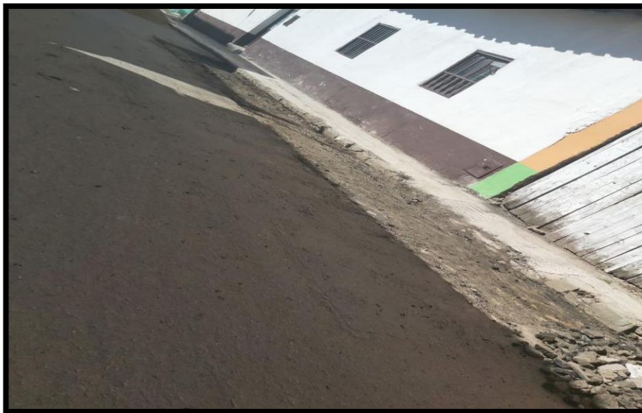
Figura 29. Patología vial lista para reconstruir.
