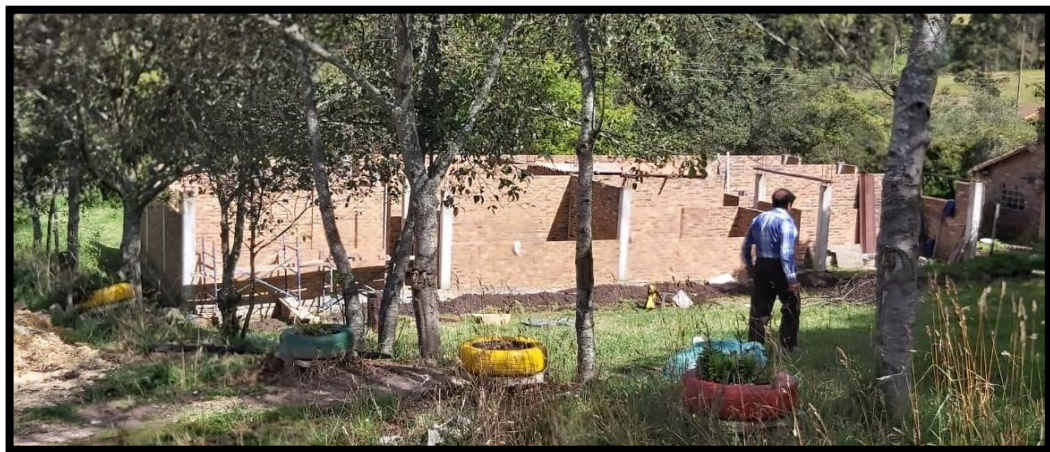
Figura 36. Construcción intervenida por falta de licencia de construcción en la vereda El Portachuelo.
