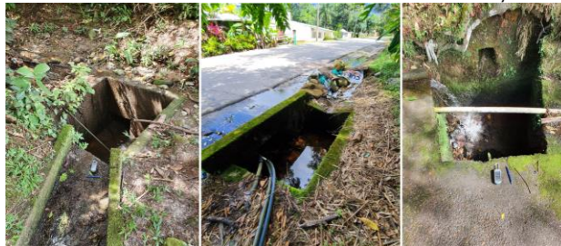
Fig. 12. ESTRUCTURAS DE DRENAJE COMPLEMENTARIAS, SUMIDEROS
