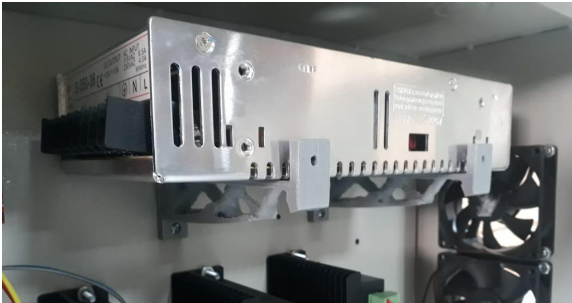
Figura 11.18 Fuente de 12 V instalada en el sistema de control modular con optimización topológica en los soportes. Fuente: Autor.
