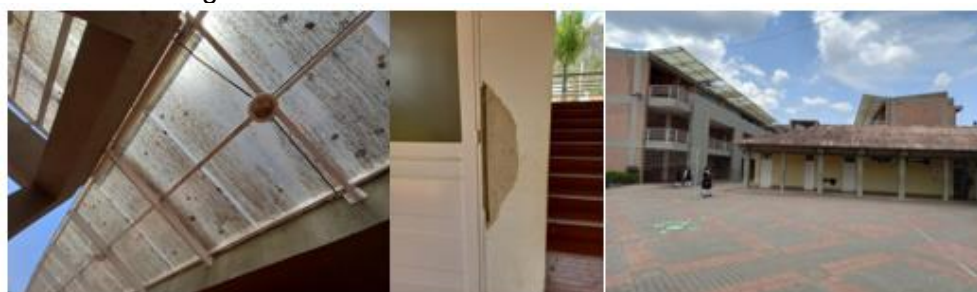
Figura 11. Afectaciones actuales de la institución.
