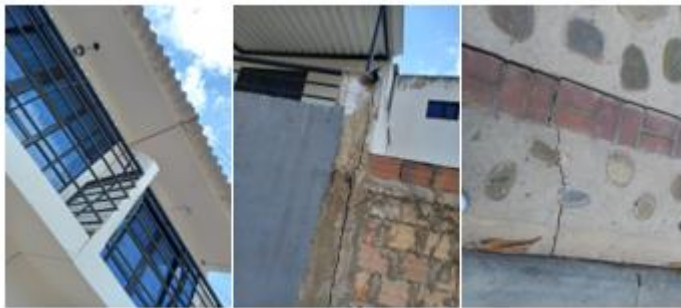
Figura 14. Separación de juntas de la vivienda.
