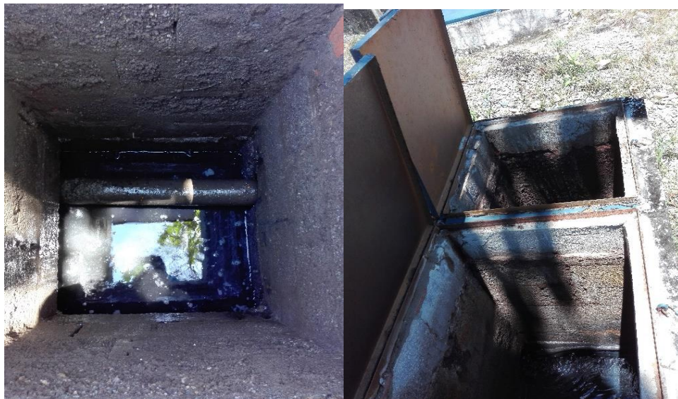
Figura 6. Tanques Filtro Percolador. Por Daniel, Escobar, 2018
