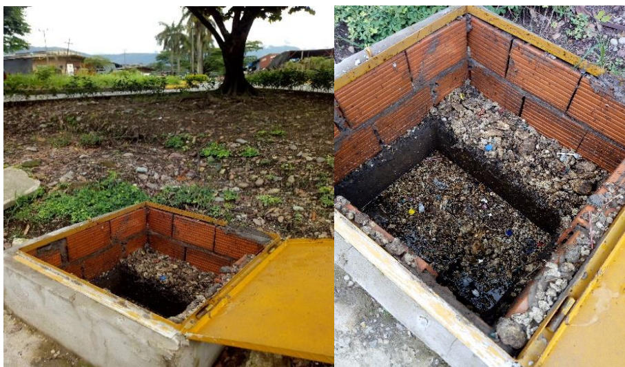
Figura 3. Caja de inspección entrada filtro anaerobio 1. Por Daniel, Escobar, 2018
