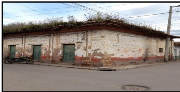
Figura 7. Visita a Obra, casa en estado de ruina.
