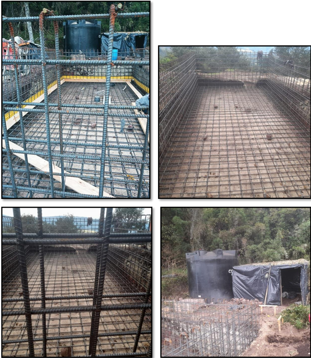
Figura 11. Visita a Obra, tanque de almacenamiento para el Acueducto de la Vereda Quebrada Grande
