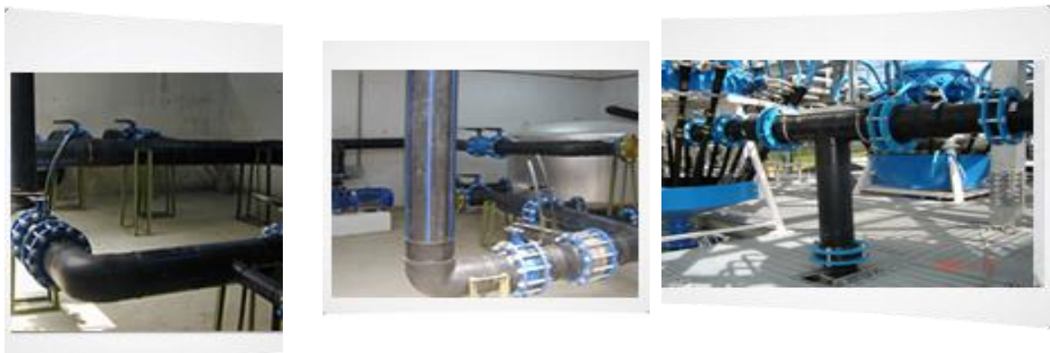
Figura 12. Tuberías para fluidos
