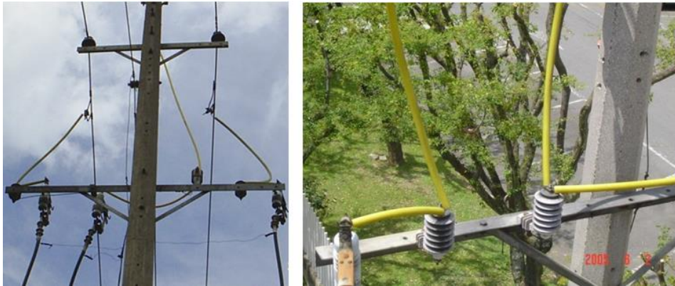
Figura 5. Tuberías de polielitelino eléctricas
