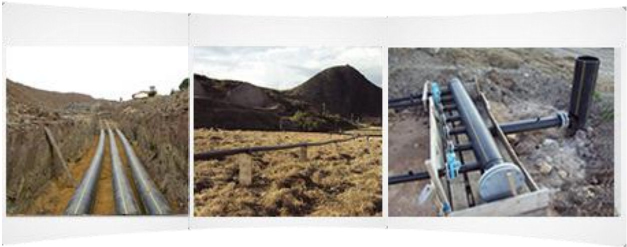
Figura 11. Tuberías para Lixiviados y Biogás
