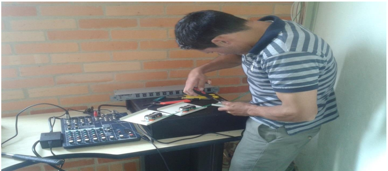
Anexo 18. Instalación de equipos de control del sonido e instalación del punto eléctrico y red en el cuarto de control.
