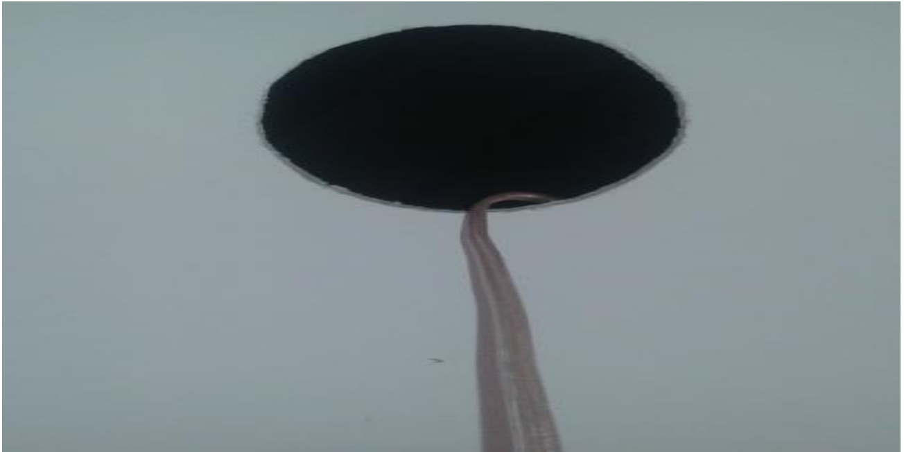
Anexo 10. Extensión del cable hasta el punto de conexión del bafle.
