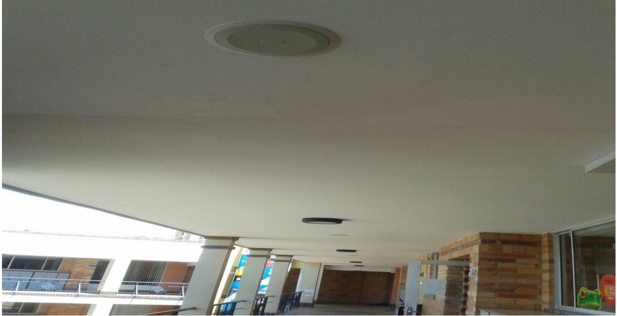
Anexo 17. Resultado final de la instalación de los bafles.
