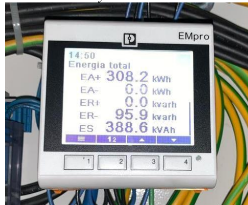
Figura 15. Analizador de red instalado en la inyectora 56
