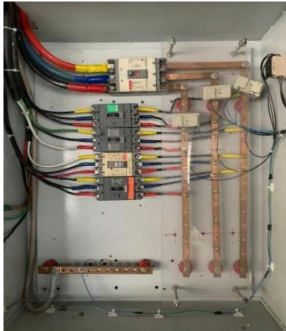
Figura 10. Analizador de red instalado en tablero de chiller.
