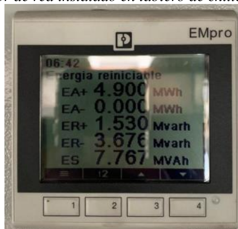
Figura 11. Lectura del analizador de red instalado en tablero de chiller.
