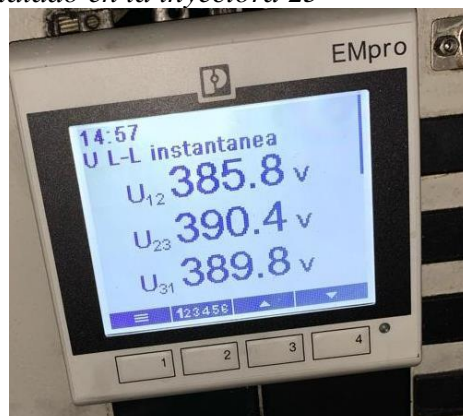
Figura 13. Analizador de red instalado en la inyectora 25
