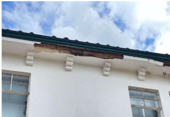
Ilustración 7 lesión desprendimientos, fuente propia, 2022.
