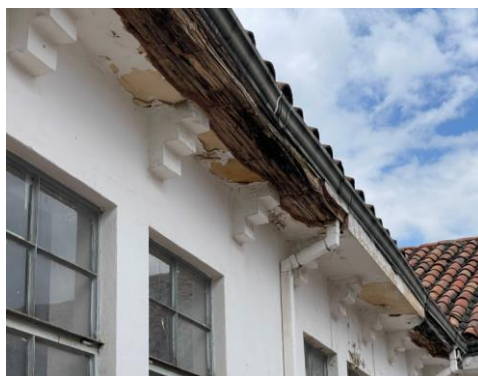
Ilustración 8 foto pudrición, fuente propia, 2022.
