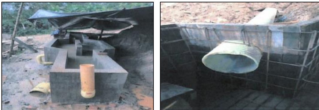
Imagen 22: Trampa de grasas de la PTAR.
