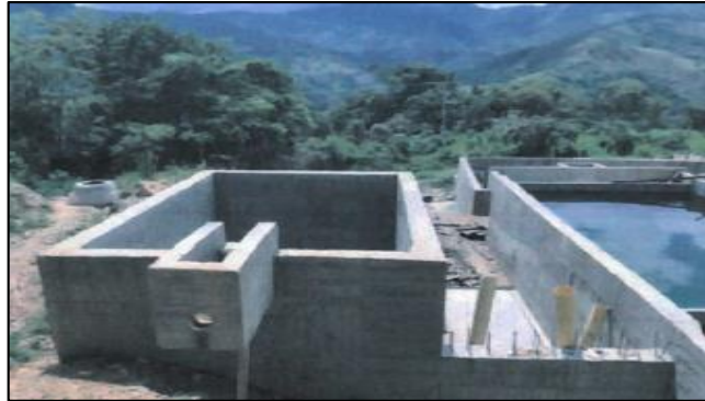
Imagen 21: tanque homogenizador de la PTAR.
