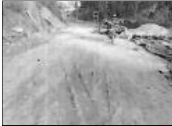
Imagen 36: Sub-base reemplazada por saturación del material.
