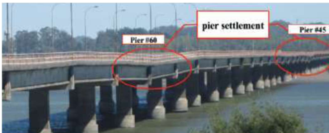
Figura 2 Asentamiento post-sísmico puente Juan Pablo II.
