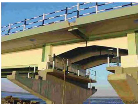
Figura 3 Daño en tablero por golpeteo longitudinal.
