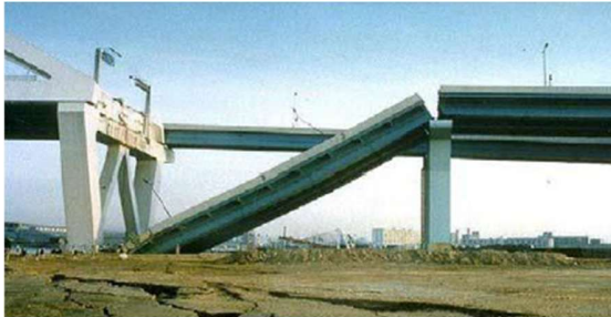
Figura 1 Falla ocasionada por desplazamientos longitudinales excesivos.
