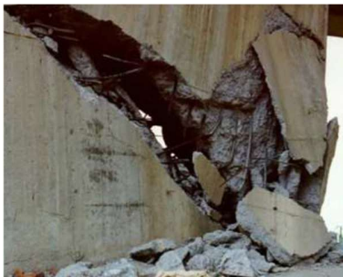
Figura 5 Terremoto de Chi Chi. Taiwan, 1999. M = 7.6 , grieta diagonal por cortante en pila de hormigón con baja cuantía de refuerzo. Puente Wushu. Taichung.
