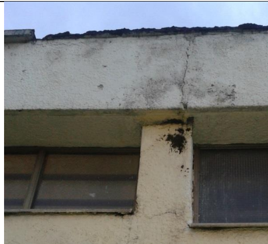
Foto 82 Grieta en Viga Canal
