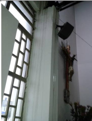
Foto 81 Infiltración de agua en columnas
