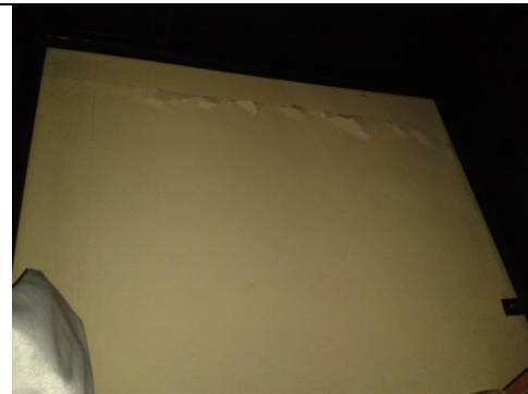
Foto 92 Desprendimiento de pañete en interior de edificación
