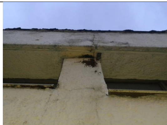
Foto 6 Grietas en viga canal Fuente: Ing. Sandra Cubides Febrero 2014
