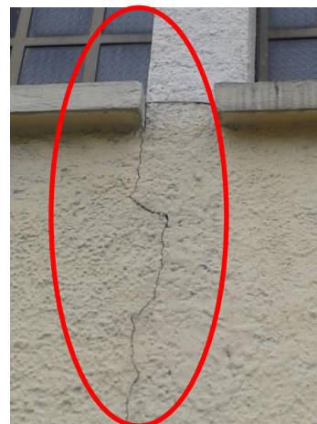
Foto 90 Fisuras a lo largo de la unión columna muro
