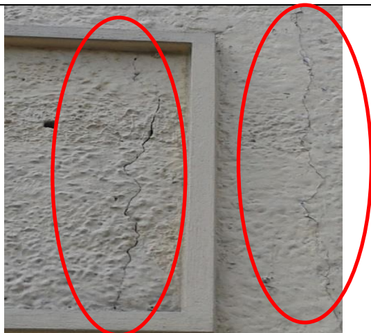
Foto 89 Fisura en fachada principal
