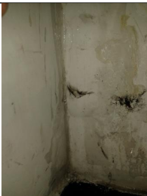
Foto 5 Humedades por bajantes Fuente: Ing. Sandra Cubides Febrero 2014
