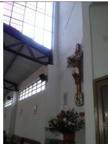
Foto 12 Filtraciones en apoyos de cerchas Fuente: Ing. Sandra Cubides Febrero 2014
