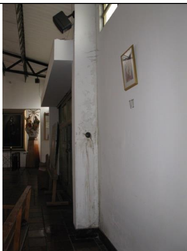
Foto 57 Perforación en columna
