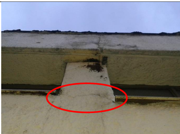
Foto 83 Fisura en columna
