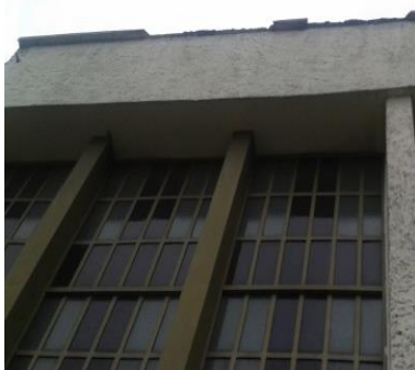
Foto 91 Presencia de moho y manchas
