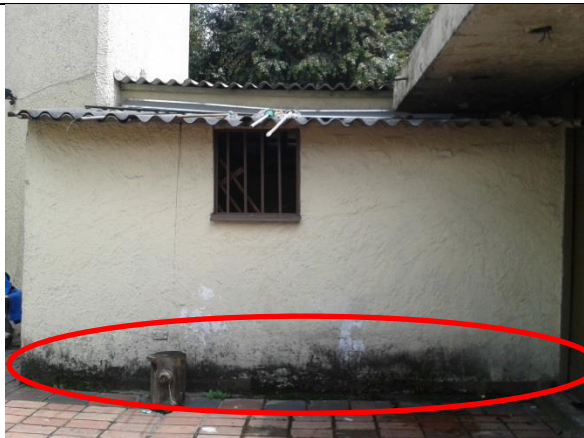
Foto 85 Presencia de moho y manchas
