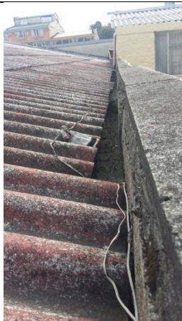
Foto 11 Viga Canal saturada Fuente: Ing. Sandra Cubides Febrero 2014
