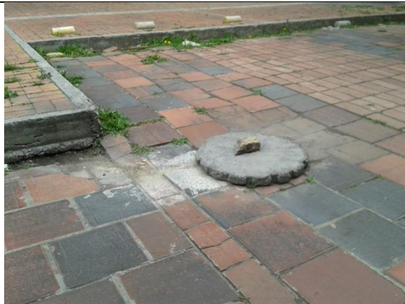
Foto 87 Desniveles en piso de adoquín
