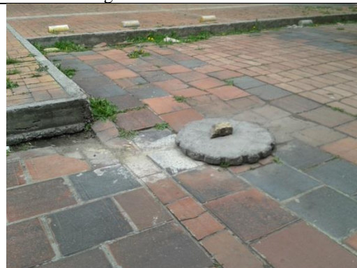
Foto 8 Desniveles en zonas aledañas al Templo Fuente: Ing. Sandra Cubides Febrero 2014
