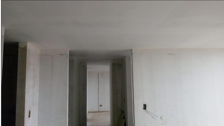
Figura 7. Techo estucado y pintado en apartamento 304.
