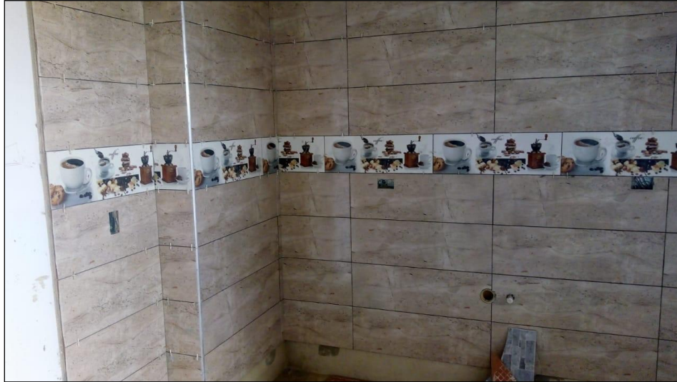
Figura 25. Enchape de baldosa cocina en apartamento 504.
