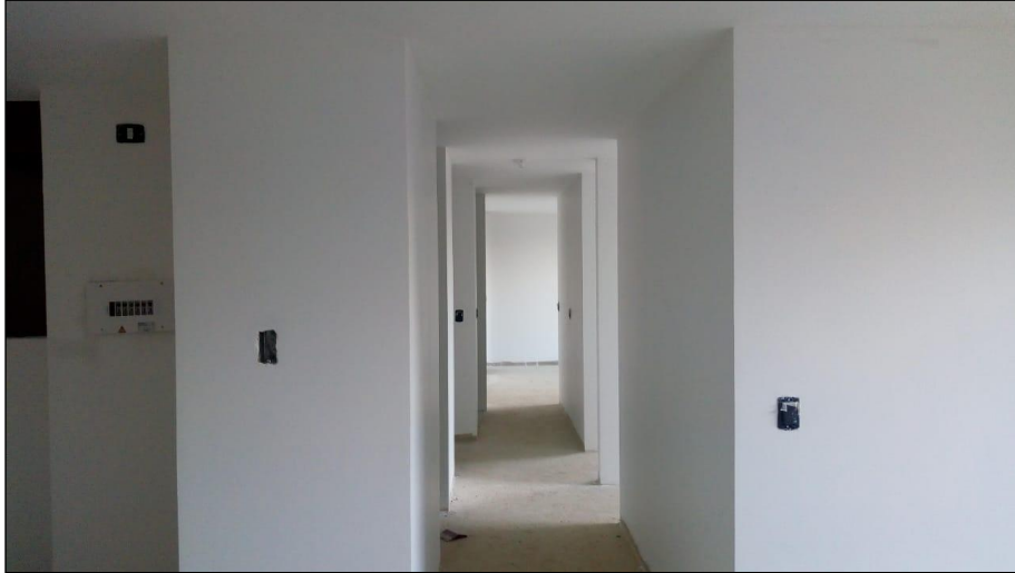
Figura 10. Muros interiores estucados y pintados en apartamento 203.
