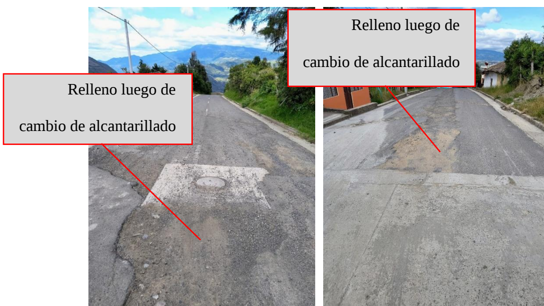
Ilustración 8, Hundimiento de calzada, fuente; elaboración Propia
