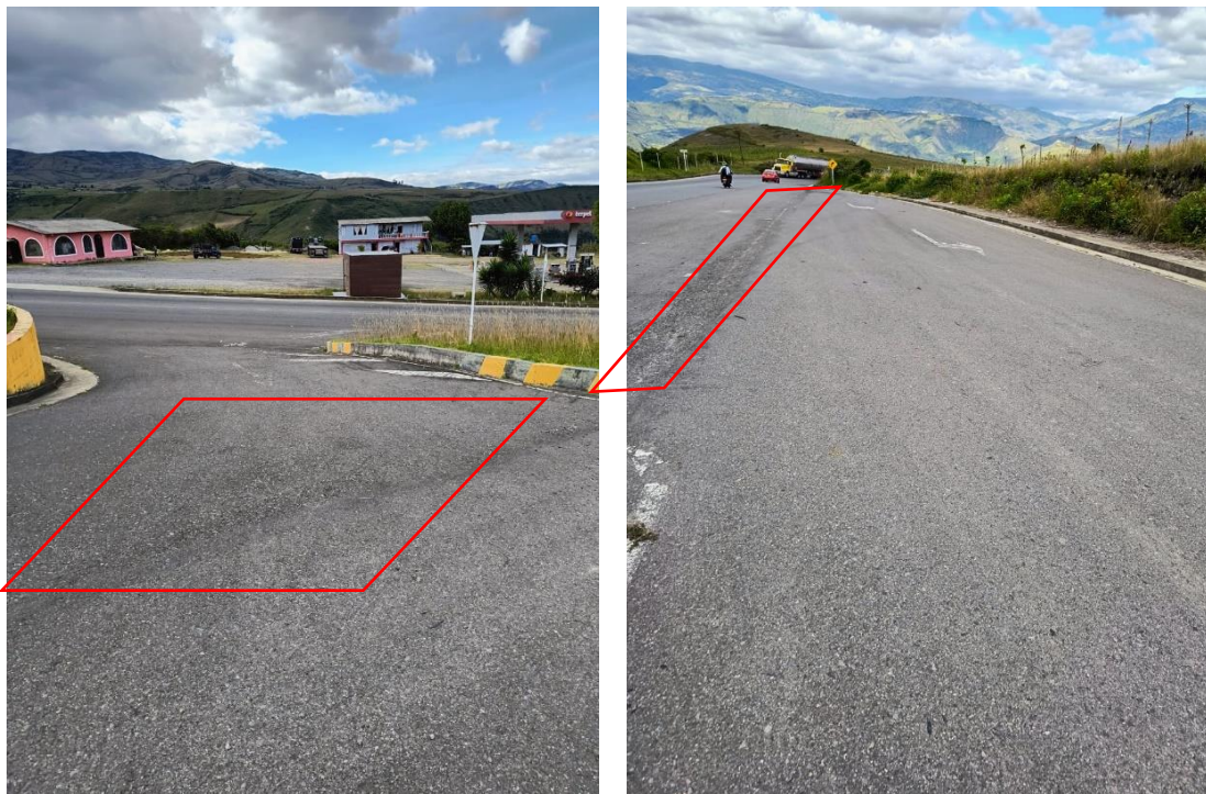
Ilustración 6, Daños superficiales, fuente; elaboración Propia
