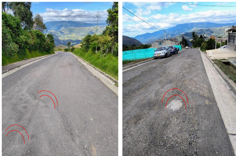
Ilustración 4, Fisuras por deslizamiento de capa, fuente; elaboración Propia
