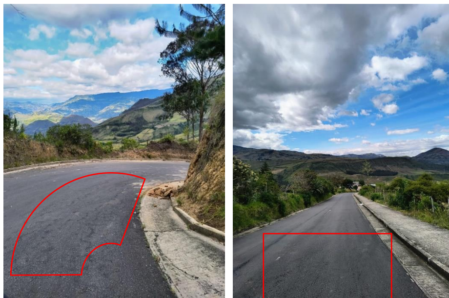
Ilustración 2, Fisuras en bloque, fuente; elaboración Propia
