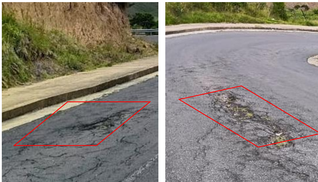
Ilustración 5, Hundimiento, fuente; elaboración Propia
