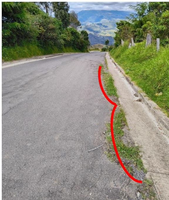
Ilustración 1, Fisuras en media luna, fuente; elaboración Propia
