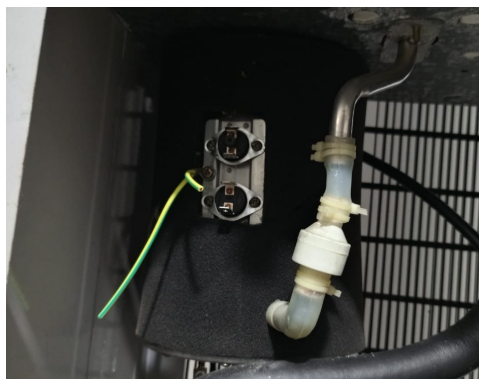
Figura 5.4.12: Resistencia instalada previamente debajo del recipiente.
