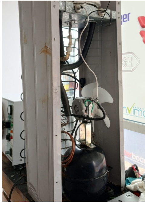
Figura 5.4.9: Estado inicial del gabinete con el sistema de compresión instalado.
