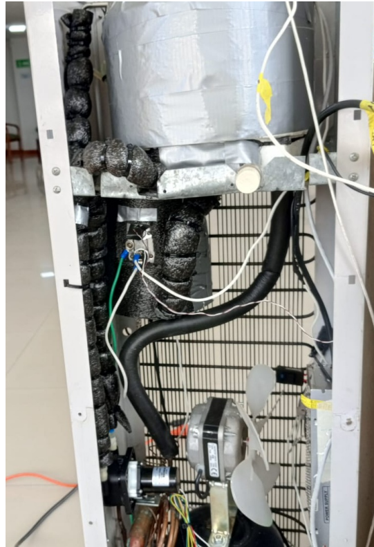
Figura 5.5.6: Sistema de circulación aislado para evitar condensacion y perdidas térmicas.
