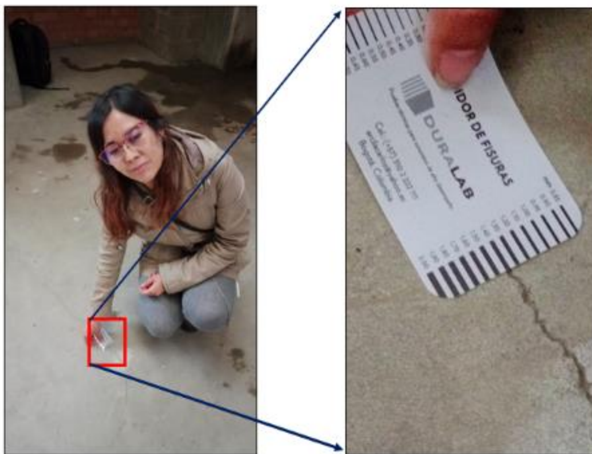
Ilustración 28 - Grietas por Dilatación y contracción
