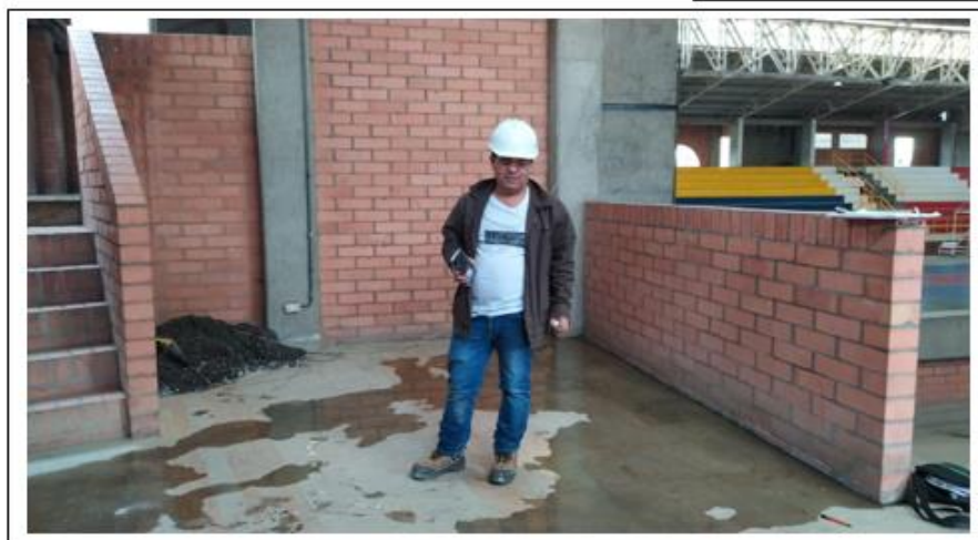
Ilustración 22 - Humedades por defectos Constructivos, Omisión de cubierta Planta palcos.
