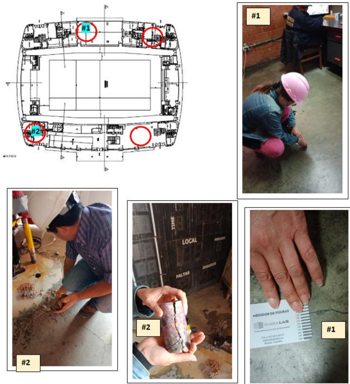
Ilustración 23 - Grietas en losas de contrapiso Planta primer piso.
