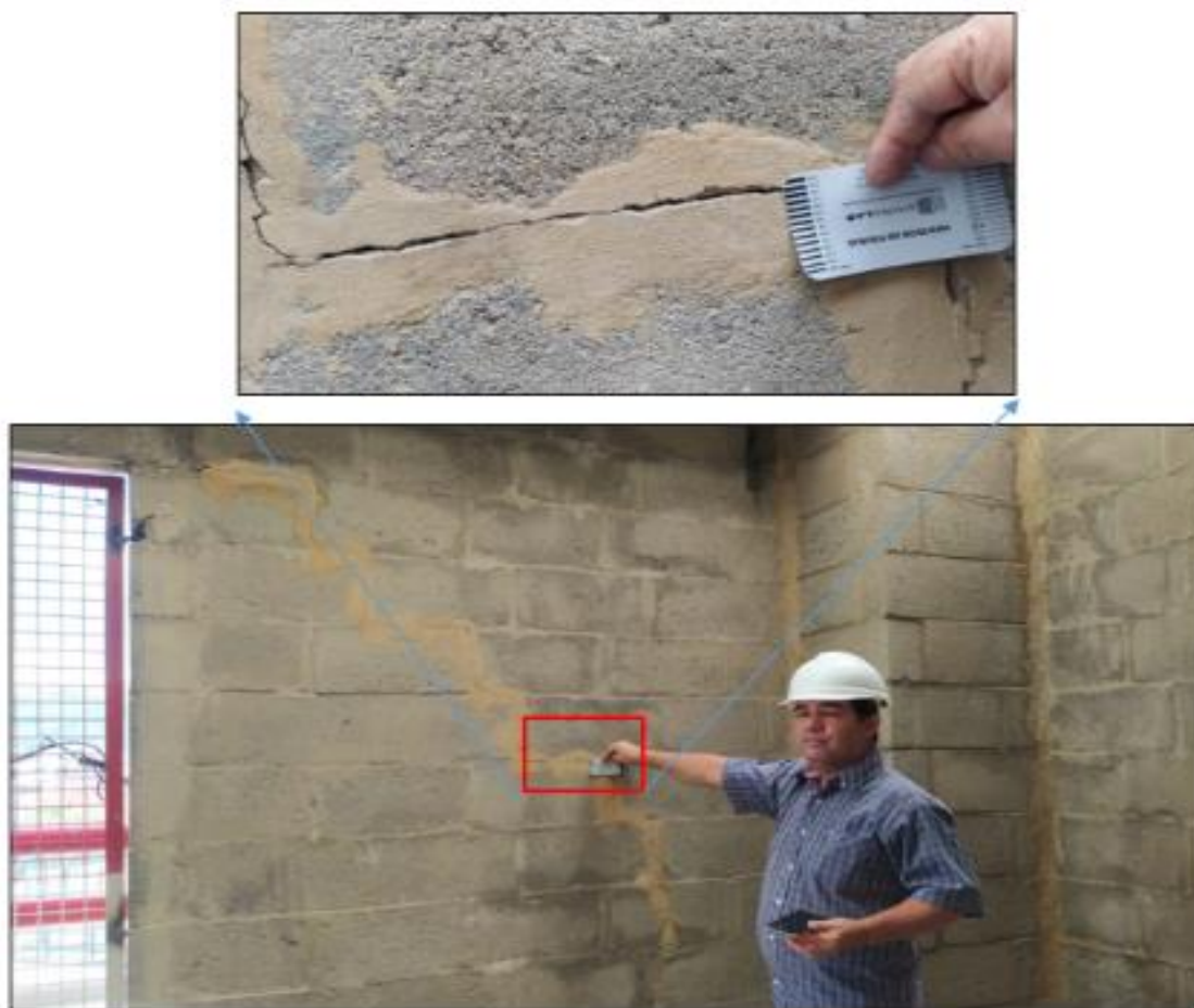
Ilustración 27 - Lesiones más Marcadas, Grietas por Cortante.
