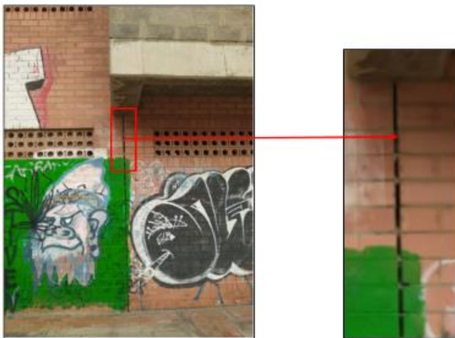
Ilustración 29 - Grietas por Desprendimiento
