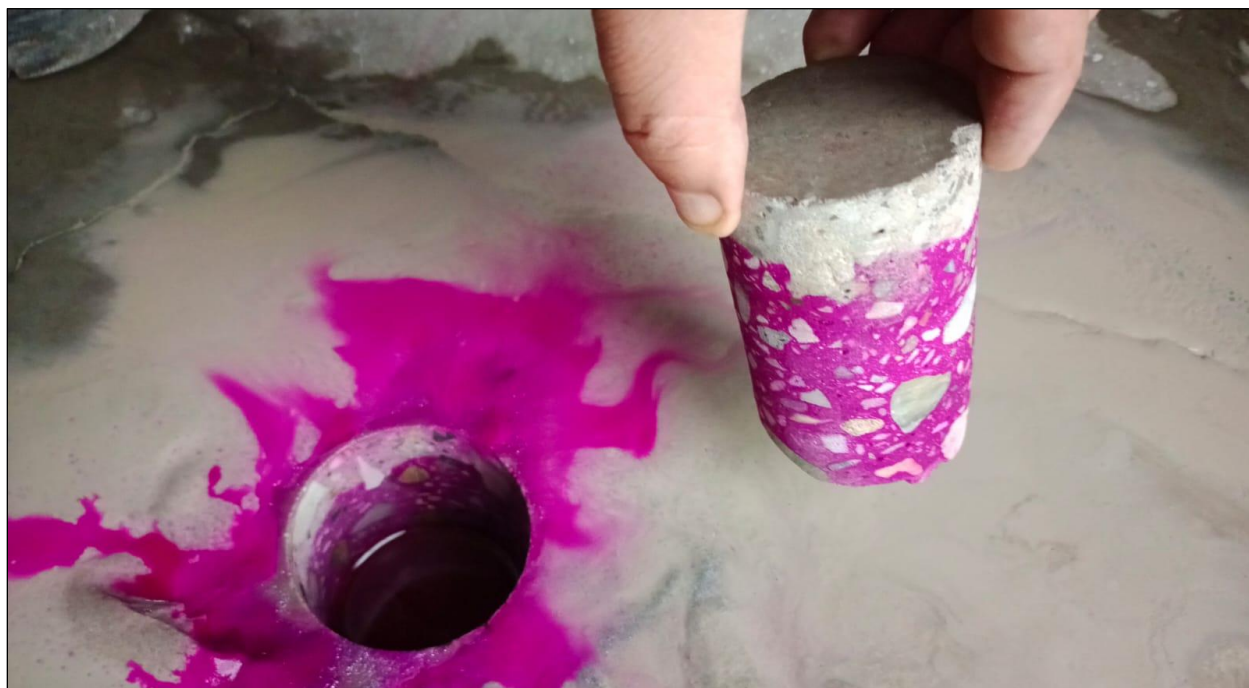
Ilustración 48 - Medida Carbonatación (nivel de PH).
