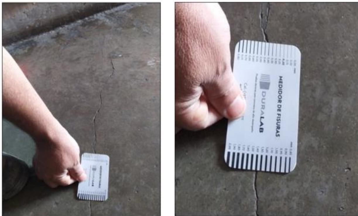
Ilustración 49 - lesiones grietas en losa de contrapiso
