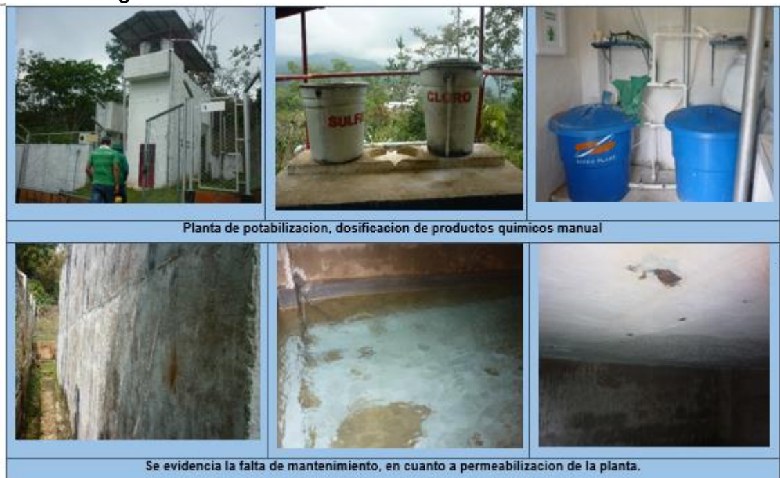
Figura 51. Imágenes. Planta de Potabilización
