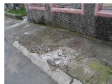
SINTOMA EN ANDEN SOBRE LA CALLE 104 A (1) Descripción del síntoma: Desquebrajamiento y hundimiento del mortero, aparición de vegetación.
