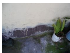
SINTOMA EN PARTE INFERIOR PARED DE PATIO (5) Descripción del síntoma: Embombamiento de revoque y pintura.
