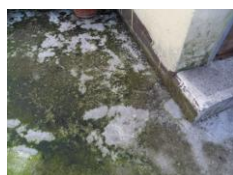
SINTOMA EN PISO DE PATIO (1) Descripción del síntoma: Tuberías galvanizadas con alto grado de corrosión externa, aparición de vegetación.
