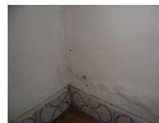
SINTOMA EN PARTE INFERIOR PARED DE SALA (3) Descripción del síntoma: Embombamiento de revoque y pintura. (Humedad por capilaridad ascendente)
