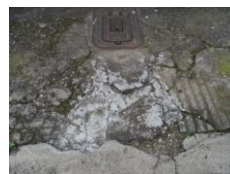
SINTOMA EN ANDEN SOBRE LA CALLE 104 A (3) Descripción del síntoma: Desquebrajamiento y hundimiento del mortero, aparición de vegetación.
