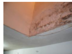
SINTOMA EN BORDE LOSA ENTREPISO DE PATIO (3) Descripción del síntoma: Eflorescencia con embombamiento de revoque y pintura.
