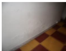
SINTOMA EN PARTE INFERIOR PARED DE SALA (2) Descripción del síntoma: Embombamiento de revoque y pintura. (Humedad por capilaridad ascendente)
