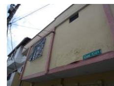
SINTOMA EN ANDEN SOBRE LA CALLE 104 A (7) Descripción del síntoma: Embombamiento, decoloración y agrietamiento del revoque.
