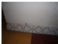
SINTOMA EN PARTE INFERIOR PARED DE SALA (1) Descripción del síntoma: Embombamiento y desprendimiento de revoque y pintura. (Humedad por capilaridad ascendente)
