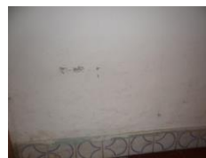
SINTOMA EN PARTE INFERIOR PARED DE COMEDOR (3) Descripción del síntoma: Embombamiento y desprendimiento de revoque y pintura.
