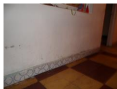
SINTOMA EN PARTE INFERIOR PARED DE COMEDOR (2) Descripción del síntoma: Embombamiento de revoque y pintura.
