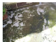
SINTOMA EN DESAGÜE DE PATIO (3) Descripción del síntoma: Evidencia de tuberías de cemento en los desagües.
