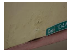
SINTOMA EN ANDEN SOBRE LA CALLE 104 A (4) Descripción del síntoma: Embombamiento, decoloración y agrietamiento del revoque.
