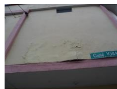
SINTOMA EN ANDEN SOBRE LA CALLE 104 A (6) Descripción del síntoma: Embombamiento, decoloración y agrietamiento del revoque.
