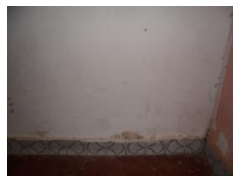
SINTOMA EN PARTE INFERIOR PARED PATIO (1) Descripción del síntoma: Embombamiento y desprendimiento de revoque y pintura.
