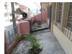
SINTOMA EN ANDEN SOBRE LA CALLE 104 A (2) Descripción del síntoma: Desquebrajamiento y hundimiento del mortero, aparición de vegetación.
