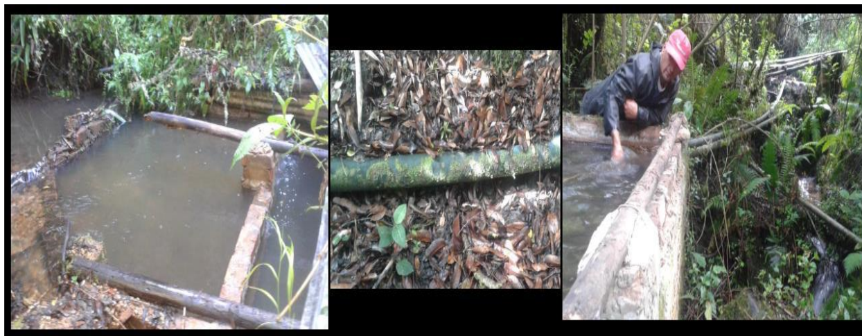
Ilustración 6 - Tanque receptor ubicado a un costado de la bocatoma.
