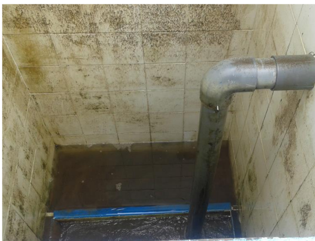
Ilustración 8 - Separación de sedimentos por retro lavado
