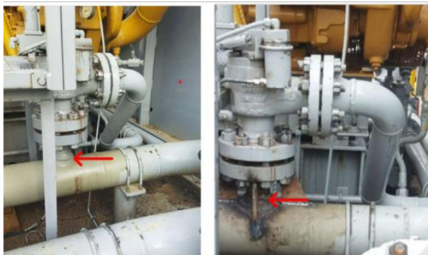
Ilustración 1. Daño en la unión soldada de la PSV de primera etapa.
