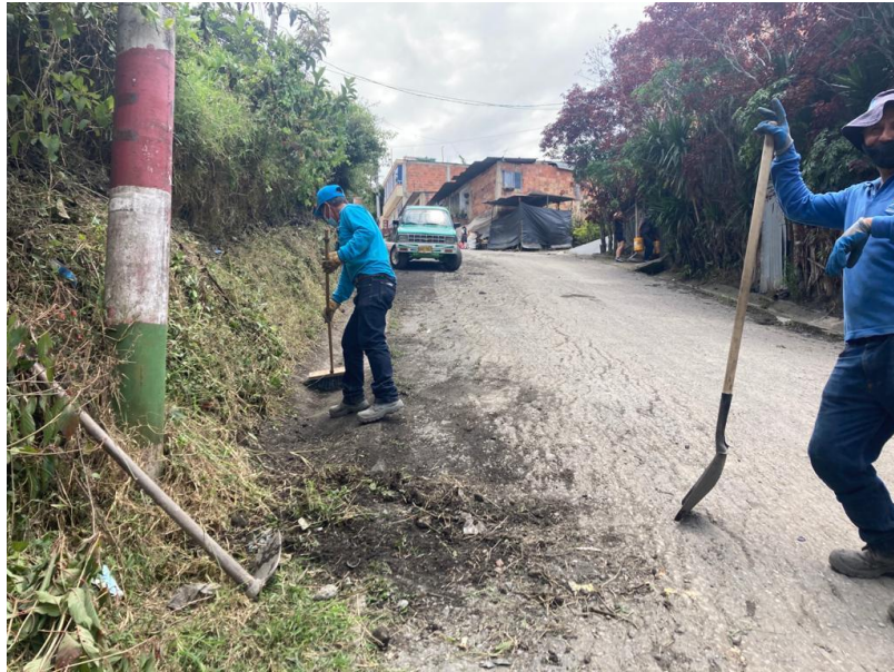
Figura 10. Día 3 mantenimiento correctivo Cra1.
