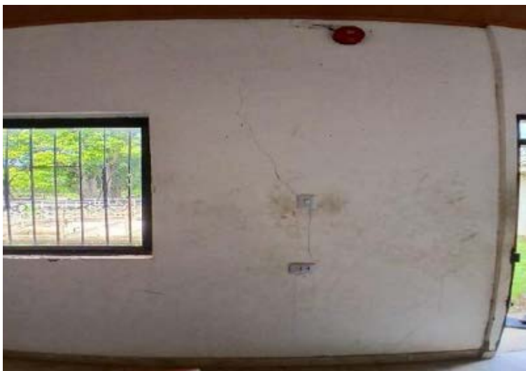
Figura 140. Grietas en los muros.
