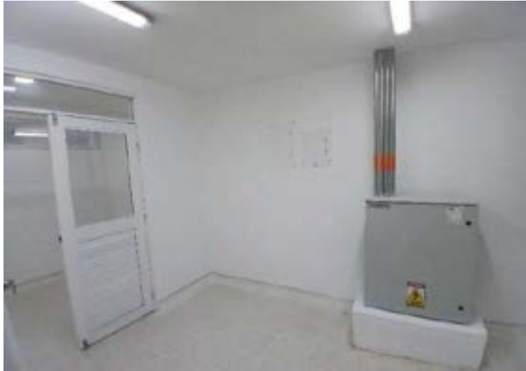
Figura 56. Cuarto de distribución eléctrica.
