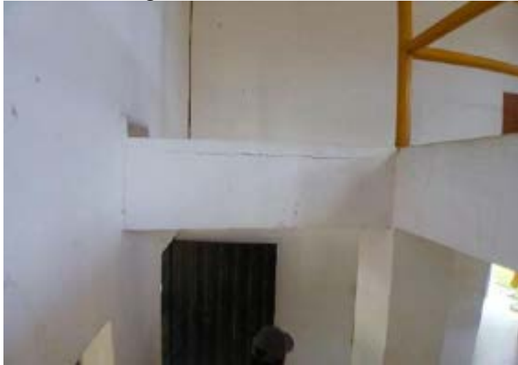
Figura 142. Grietas en elemento viga.
