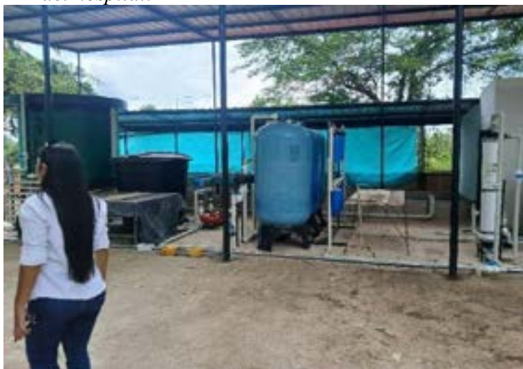
Figura 99. Mini PTAP del hospital.
