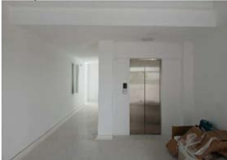
Figura 73. Ascensor tercer piso.
