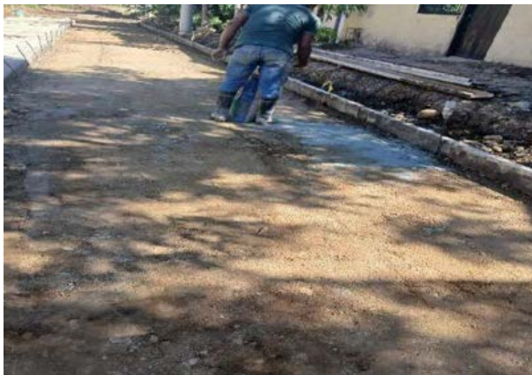
Figura 231. Control de humedad.
