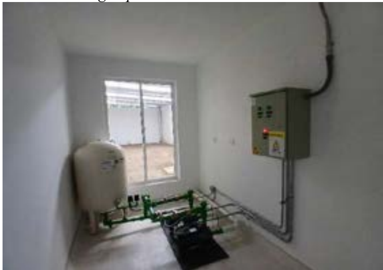
Figura 57. Cuarto de bomba de agua potable.
