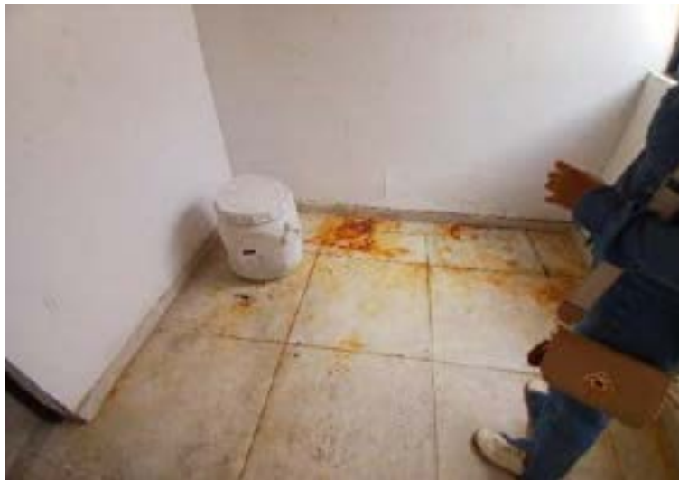
Figura 139. Presencia de oxido en la habitación.
