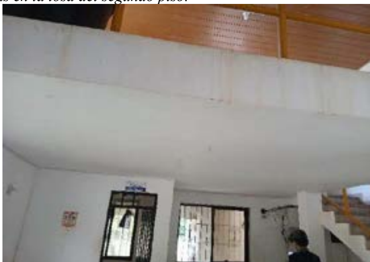
Figura 141. Grietas en la losa del segundo piso.
