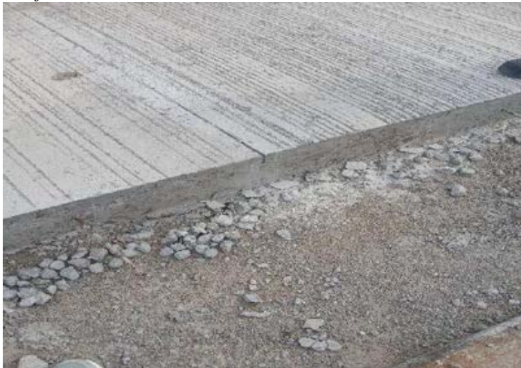
Figura 119. Líneas de falla inducida.
