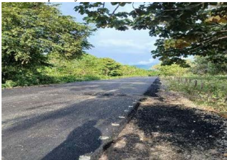
Figura 207. Residuos de la carpeta asfáltica.
