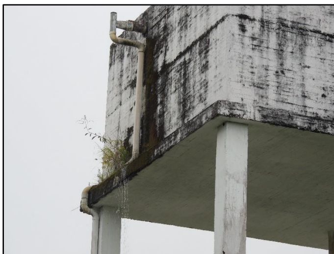
Fotografía 20. Escape tubería entrada y salida Tanque aéreo (Tatiana Zapata, 2019).
