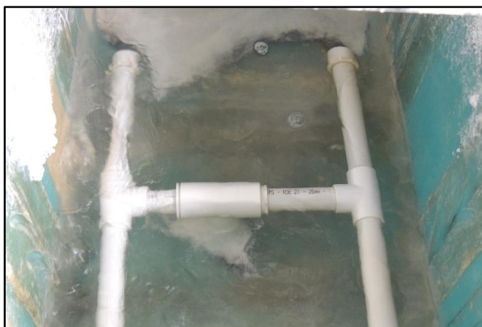
Fotografía 23. Tanque de tolva (Tatiana Zapata, 2019).
