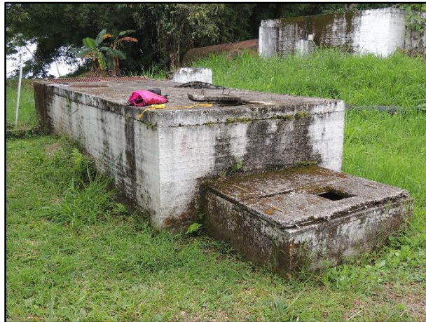
Fotografía 1. Caja de repartición (Tatiana Zapata, 2019).
