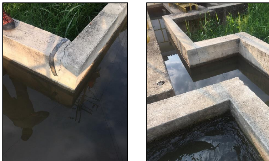
Fotografía 31. Fisuras del canal de sedimentación (Tatiana Zapata, 2019).
