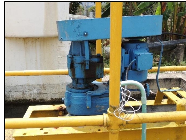
Fotografía 42. Motor de mezclador de paletas (Tatiana Zapata, 2019).
