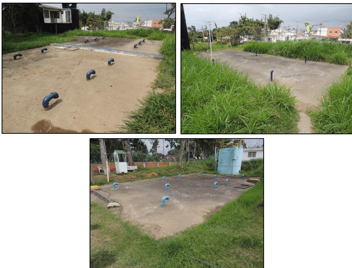
Fotografía 13. Tanques de Almacenamiento (Tatiana Zapata, 2019).
