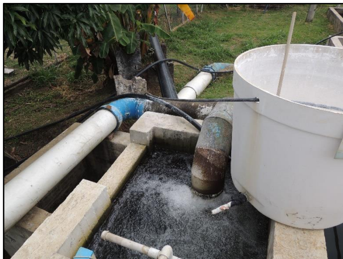
Fotografía 4. Cámara de Aquietamiento (Tatiana Zapata, 2019).
