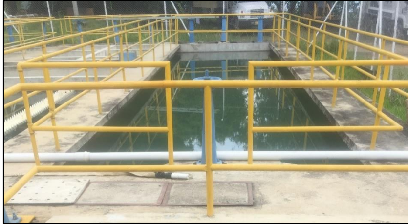
Fotografía 9. Sedimentador Convencional (Tatiana Zapata, 2019).
