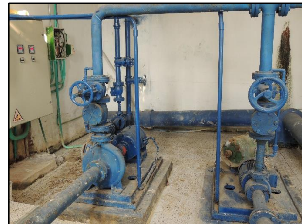
Fotografía 45. Bombas nuevas de filtros VOGES (Tatiana Zapata, 2019).
