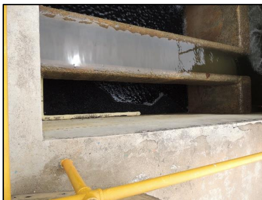
Fotografía 32. Abombamiento paredes de filtros (Tatiana Zapata, 2019).
