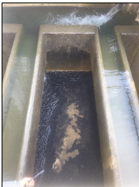
Fotografía 11. Filtros (Tatiana Zapata, 2019).
