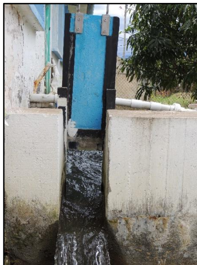
Fotografía 7. Vertedero mezcla rápida hidráulica (Tatiana Zapata, 2019).
