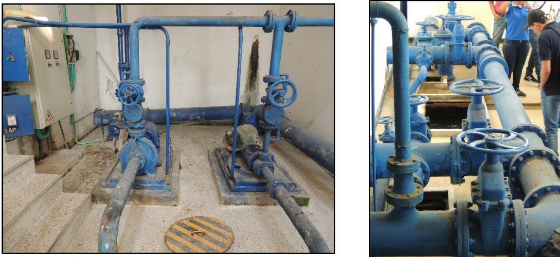
Fotografía 15. Cuarto de bombas (Tatiana Zapata, 2019).
