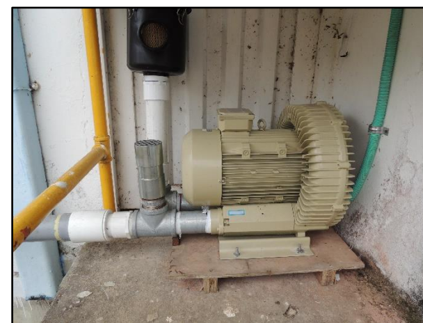
Fotografía 46. Bomba de aire PUMPOWER (Tatiana Zapata, 2019).
