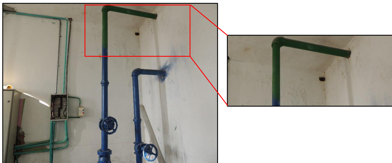
Fotografía 28. Cuarto de bombas (Tatiana Zapata, 2019).
