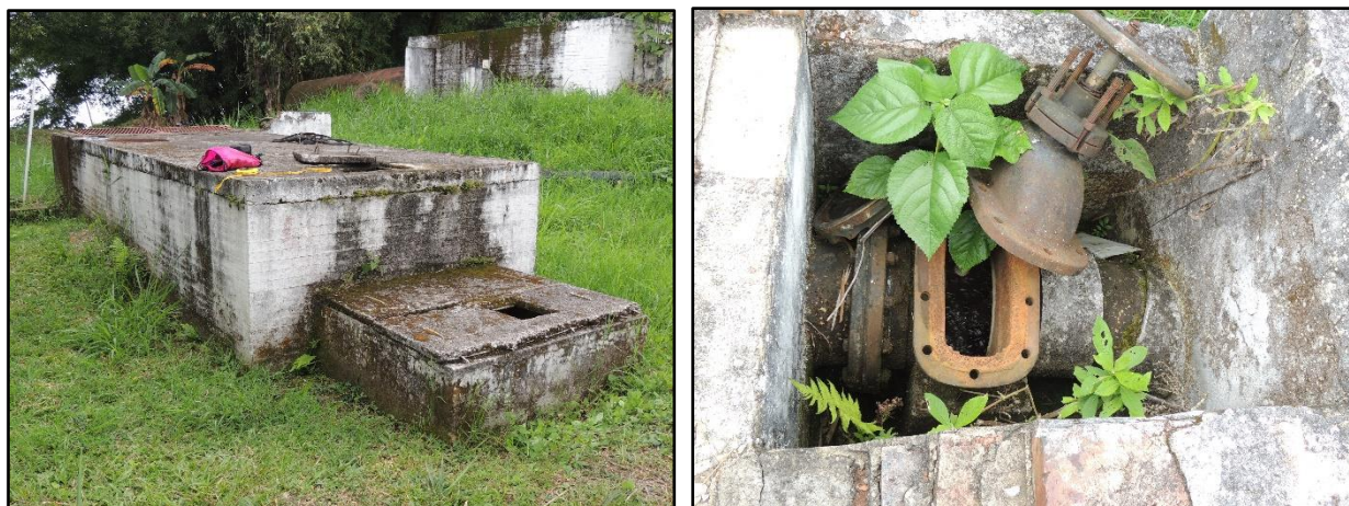
Fotografía 19. Válvulas de la Caja de Repartición (Tatiana Zapata, 2019).
