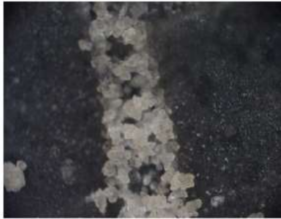
Ilustración 3. Cristalización formada en grietas (Homma, Mihashi, & Nishiwaki, 2009)
