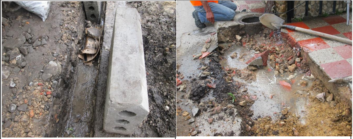
Fotografía 59 y 60. Ruptura de tubería de agua.
