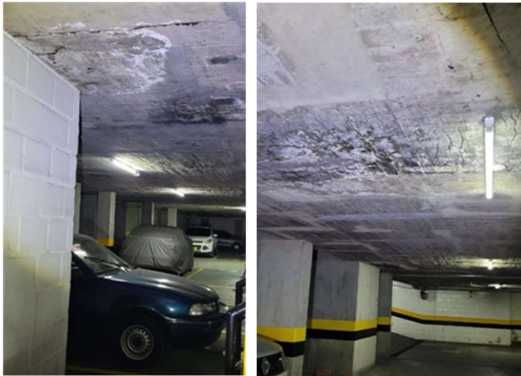
Figura 17. Humedad en placa de entrepiso, escalera y pasillo Torre 6 NIVEL -1
