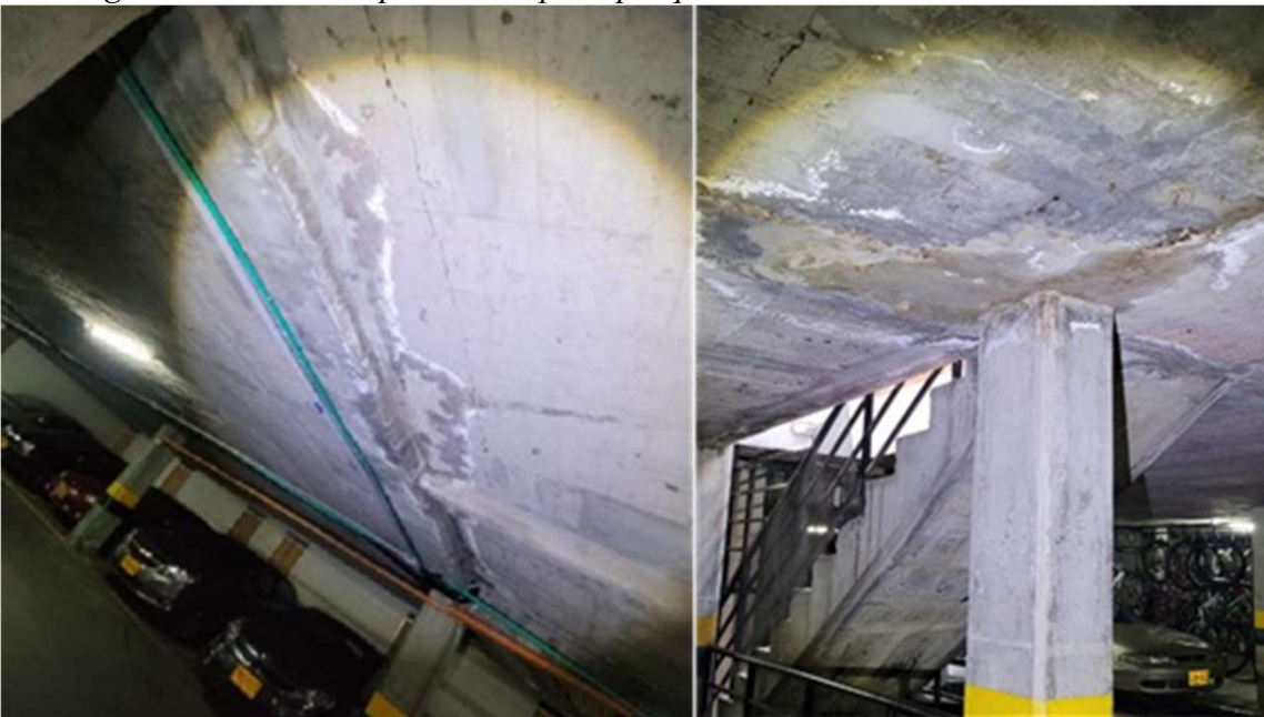
Figura 18. Humedad placa entrepiso, parqueadero visitantes Torre 6 NIVEL -1
