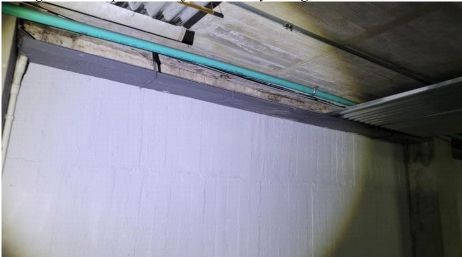
Figura 22. Captación de filtraciones y desagües Torre 7 NIVEL -1
