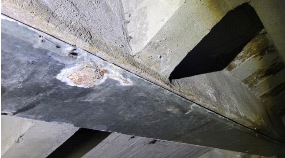
Figura 21. Filtraciones en placa de entrepiso, rampa parqueadero NIVEL -1
