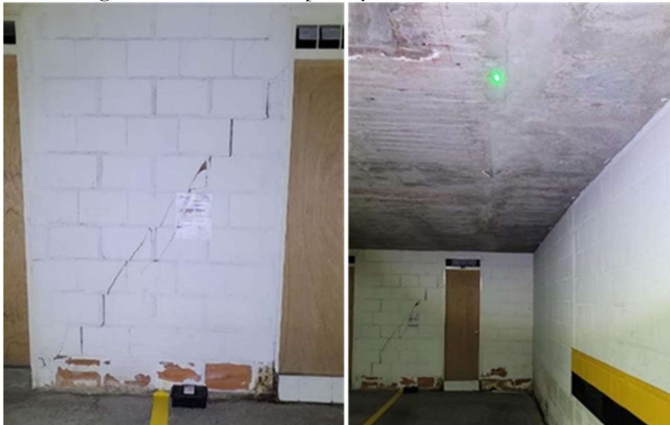
Figura 16. Fisuras en la placa y muro divisorio NIVEL -1
