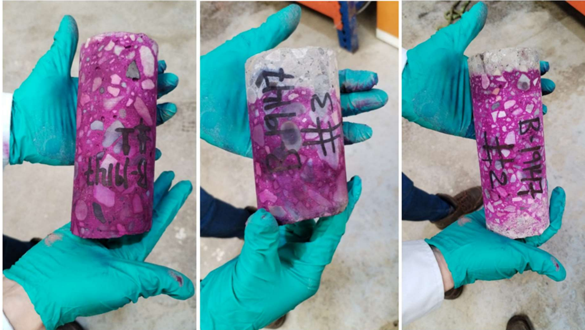
Figura 37. Carbonatación presente en las extracciones
