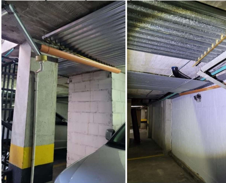
Figura 23. Captación de filtraciones y desagües Torre 7 NIVEL -1
