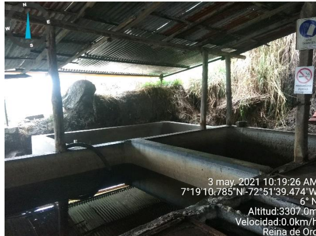
Imagen. 15 Tanques de cianuro (Percolación y Agitación)
