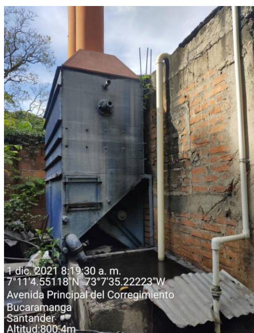
Imagen. 27 Lavador de gases
