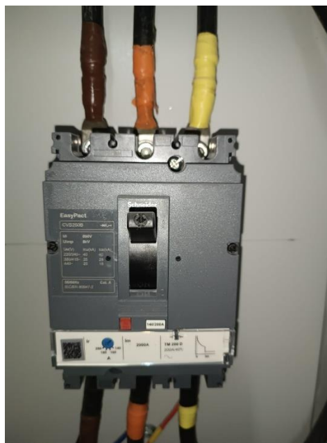
Figura 28 Ejemplo de un Interruptor afectado
