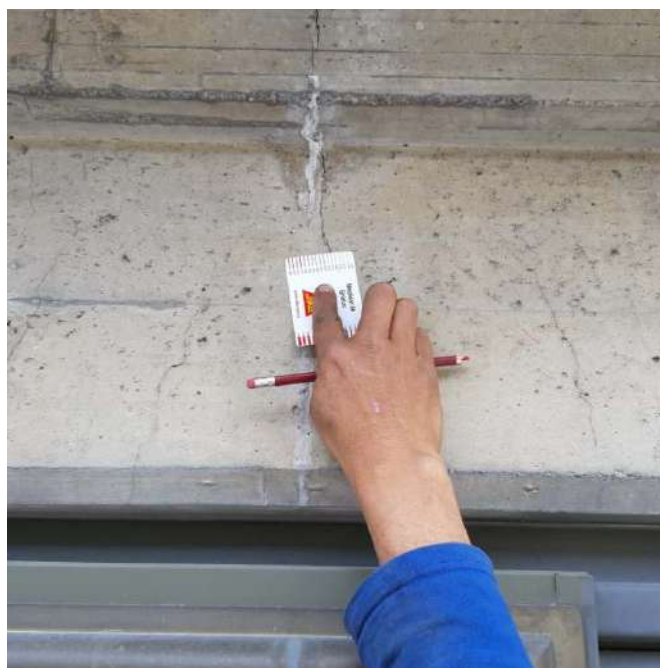
Figura 29. Fisuras sobre los elementos en concreto, posiblemente coincidiendo con localización del refuerzo transversal.
