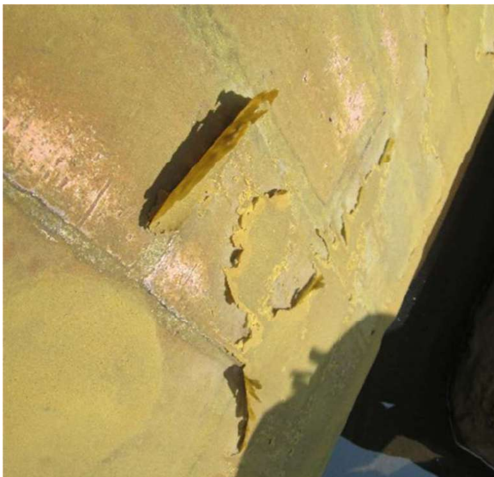
Figura 9. Estado inicial de la impermeabilización con poliurea. Fuente propia.
