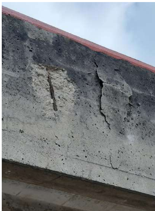
Figura 26. Desprendimiento del concreto, recubrimientos del acero deficientes.
