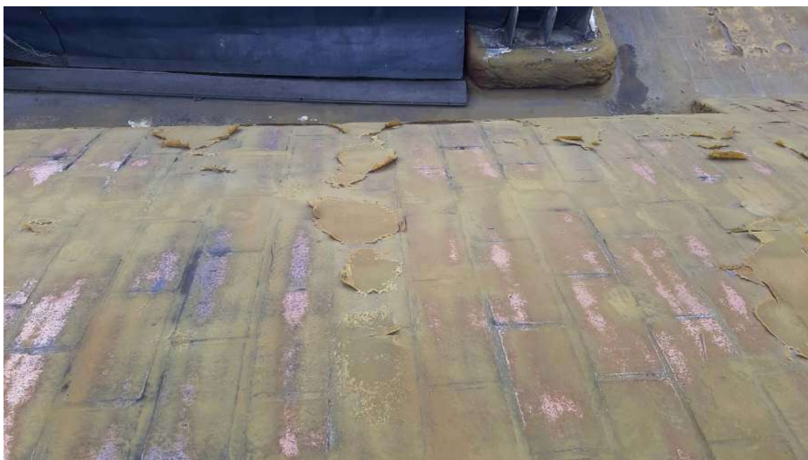
Figura 4. Vista general de la cubierta piso 5, estado de impermeabilización aplicada anteriormente. Fuente propia.
