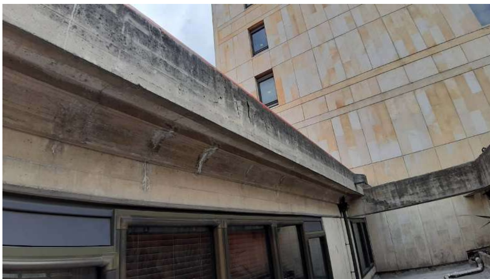
Figura 25. Eflorescencias sobre vigas en concreto.
