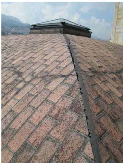
Figura 10. Estado inicial de las cúpulas de cubierta. Fuente propia.
