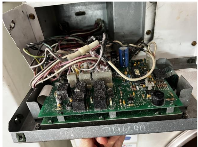
Figura 4. Estado tarjeta de control secadora N. 5.
