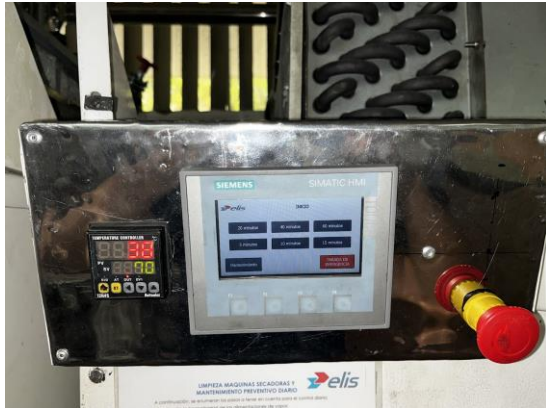
Figura 17. Panel de operación.
