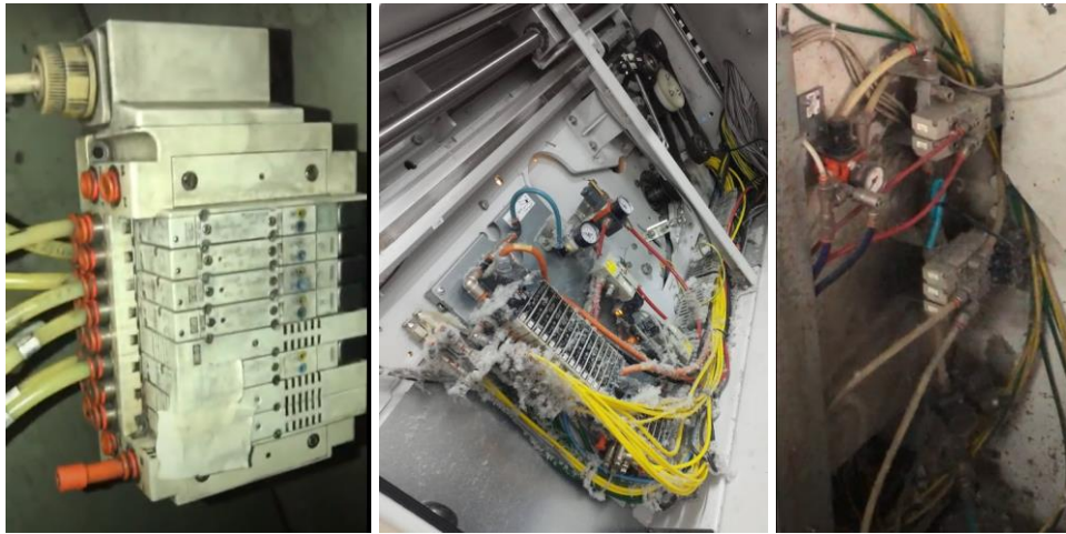
Figura 29. Fotografías revisión y reporte de estado sistemas neumáticos de equipos.
