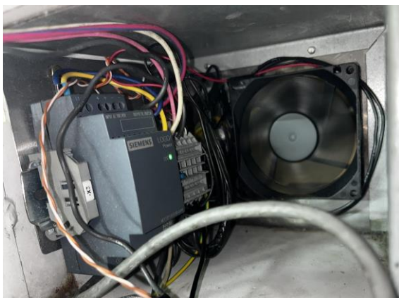
Figura 19. Borneras y fuente de panel de operación.
