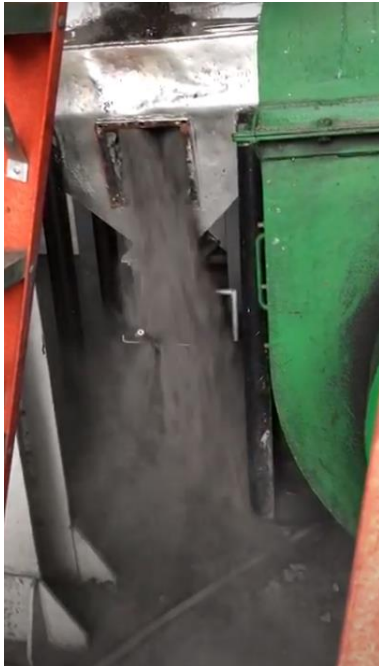
Figura 26. Fotografía limpieza conductos de ceniza de caldera de biomasa.
