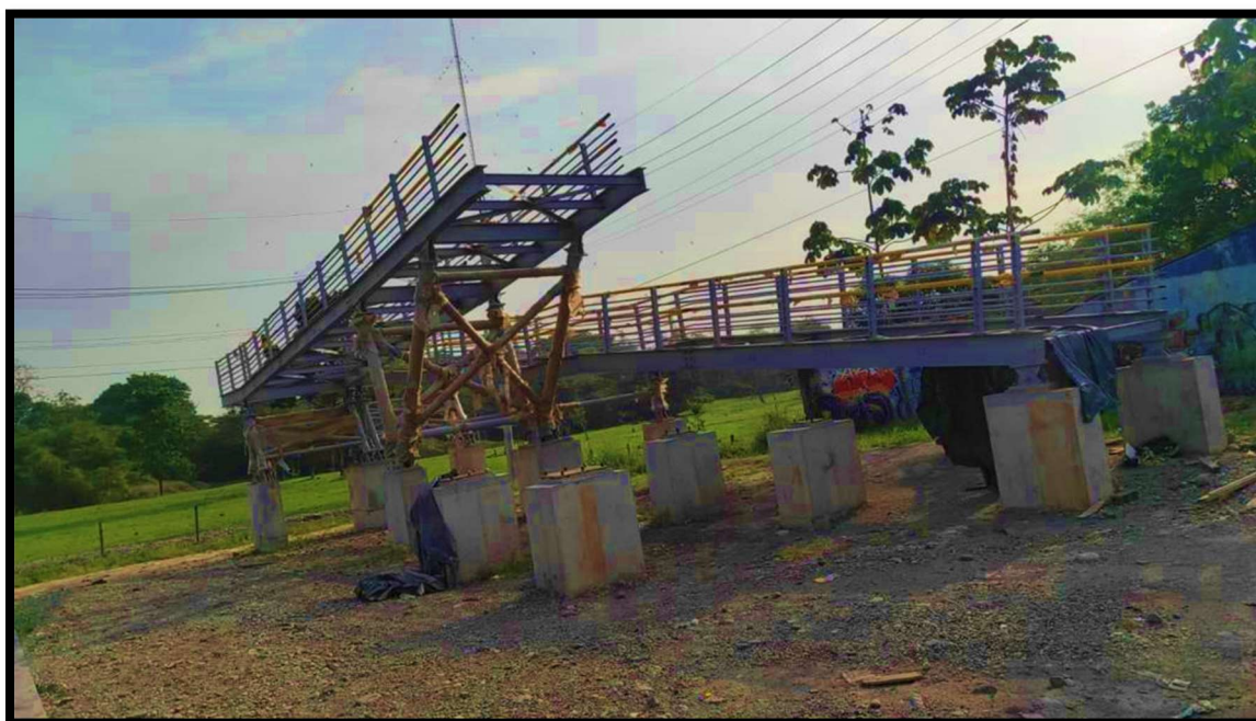
Ilustración 7. Estado actual puente peatonal Catumare K1+530 calzada izquierda
