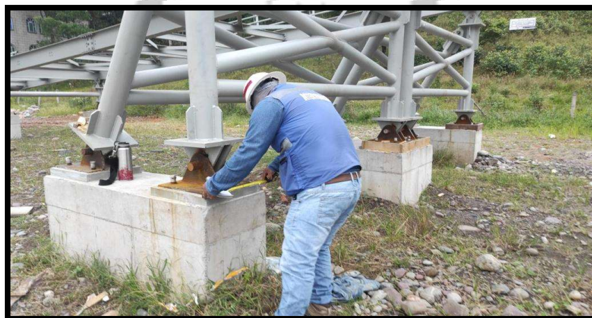
Ilustración 1 y 2. Anclajes- placa base puente peatonal Catumare Abs K1+530 calzada derecha e izquierda
