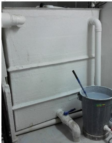
Fotografía 3. Tanque de homogenización
