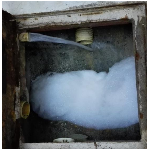
Fotografía 7. Salida del agua residual tratada de la planta de tratamiento
