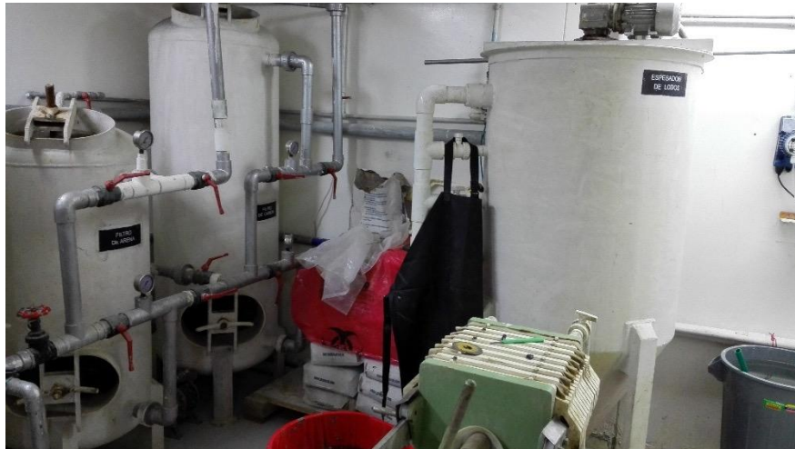
Fotografía 6. Filtro de arena, filtro de carbón activado, espesador de lodos y prensa de lodos
