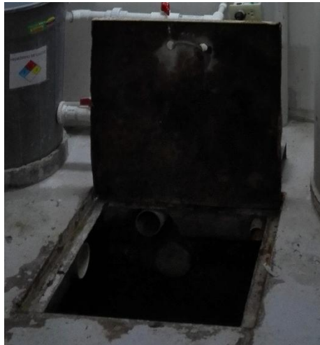
Fotografía 1. Caja de aforo agua residual tratada
