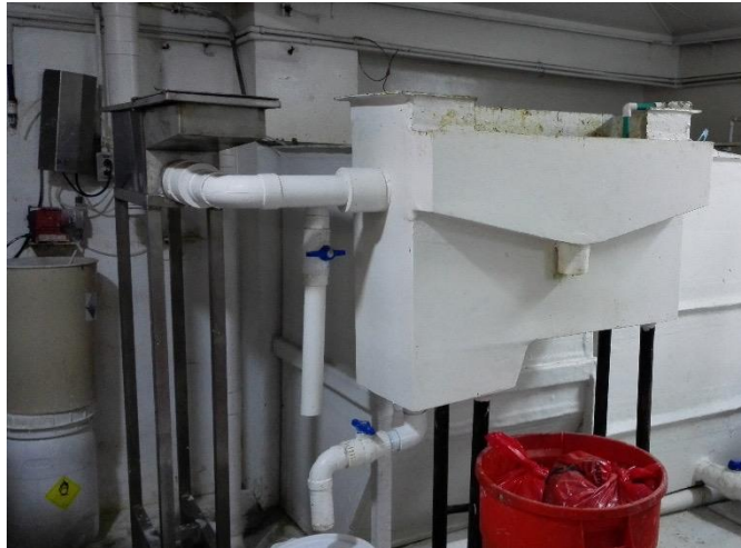
Fotografía 2. Estructura de entrada y trampa de grasas.
