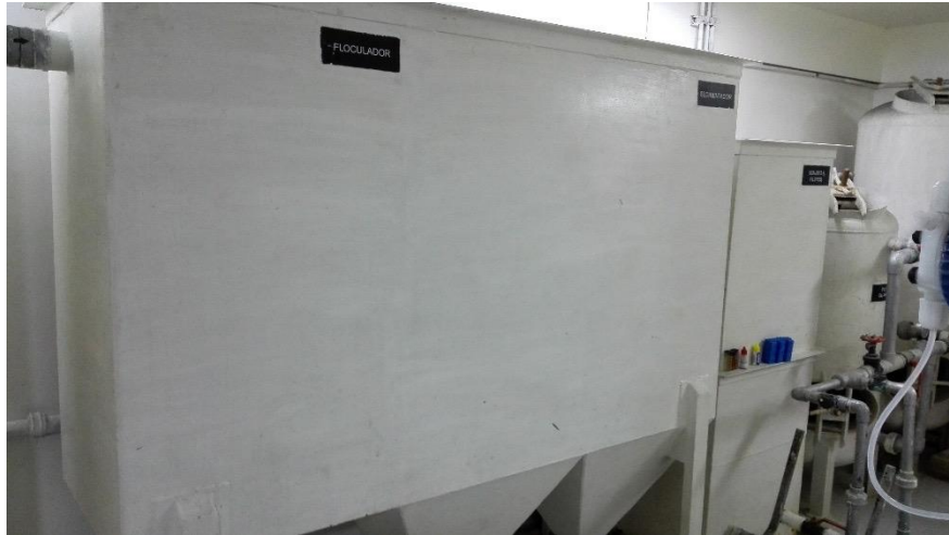
Fotografía 5. Floculador y sedimentador
