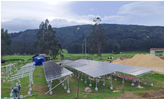
Ilustración 2 Mesas solares SSFV 73.6 Kwp
