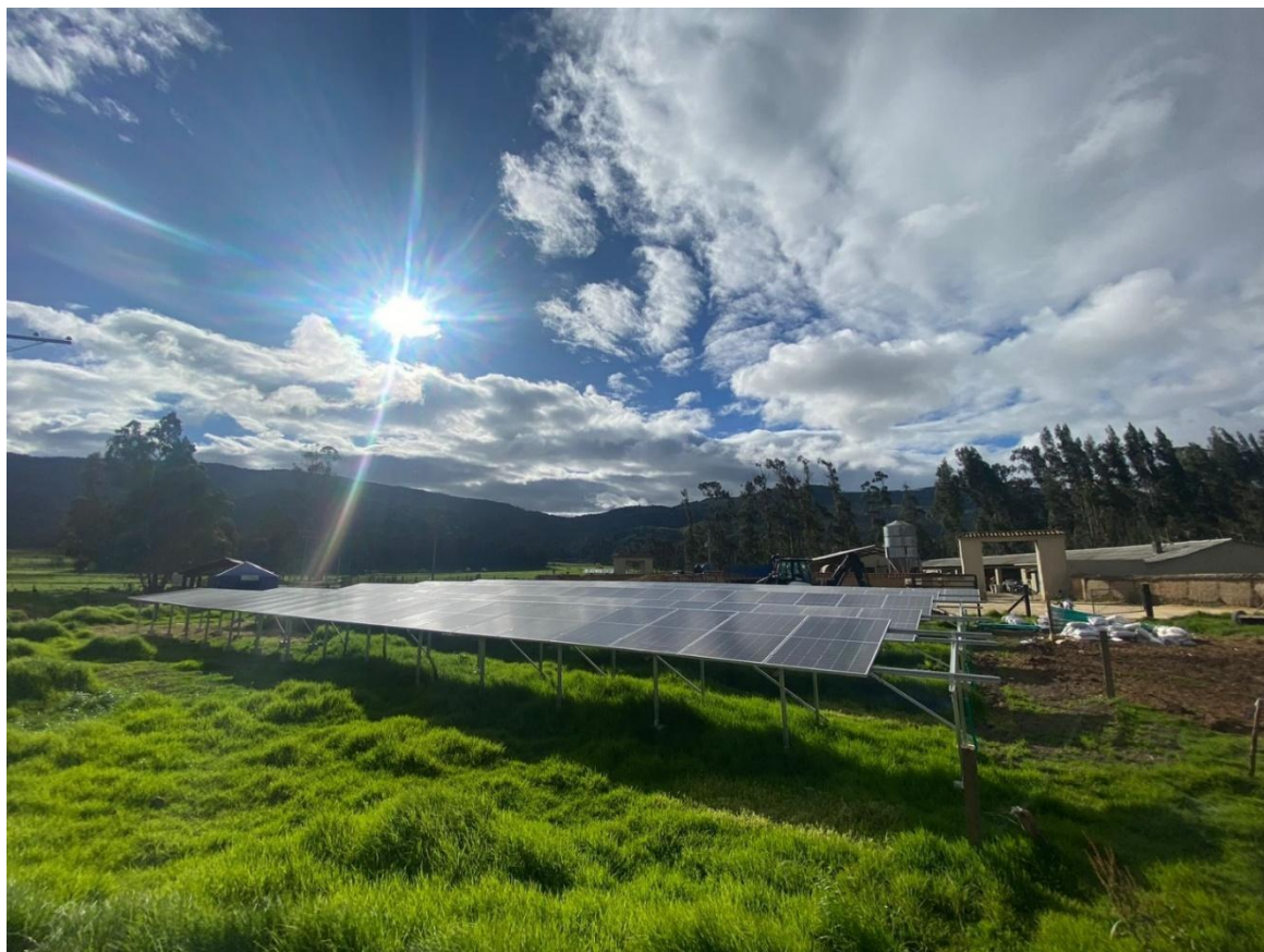
Ilustración 8 Vista final SSFV 73.6 Kwp
