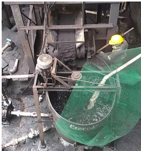
Figura 5. Tanque de mezcla planta lavadora
