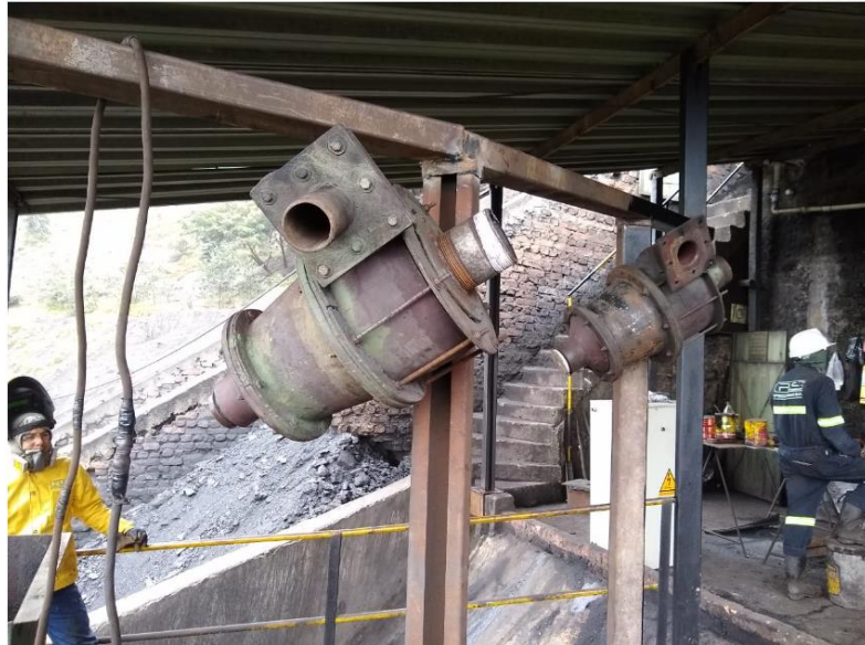
Figura 9. Disposición hidrociclones en la planta lavadora
