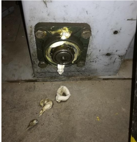
Ilustración 41. Cojinete con excesiva lubricación
