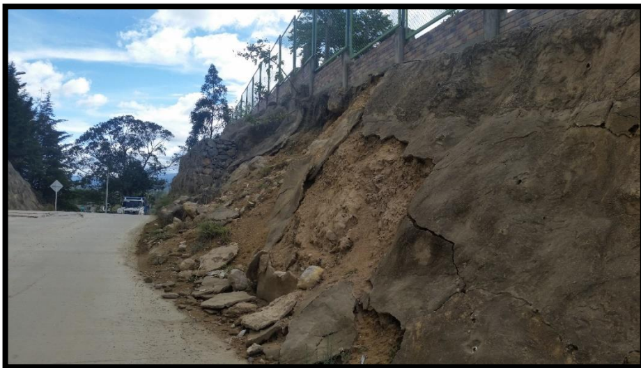
Imagen 60. Deslizamiento, escuela Monjas
