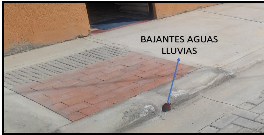
Imagen 54. Bajantes aguas lluvias
