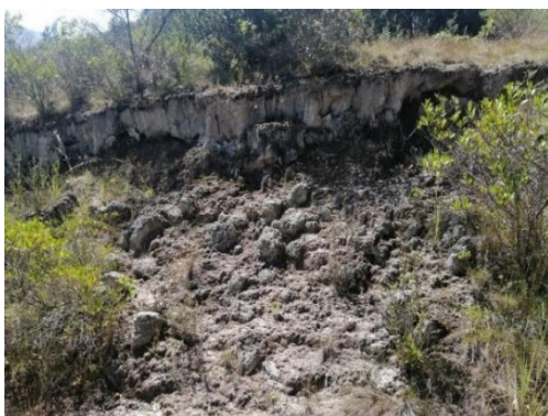
Figura 16. Desprendimiento de masas
