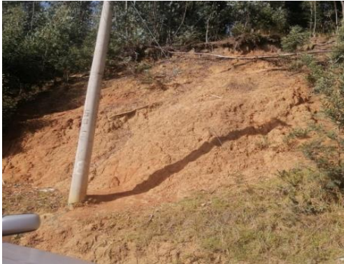
Figura. 18 Desprendimiento de posta de luz
