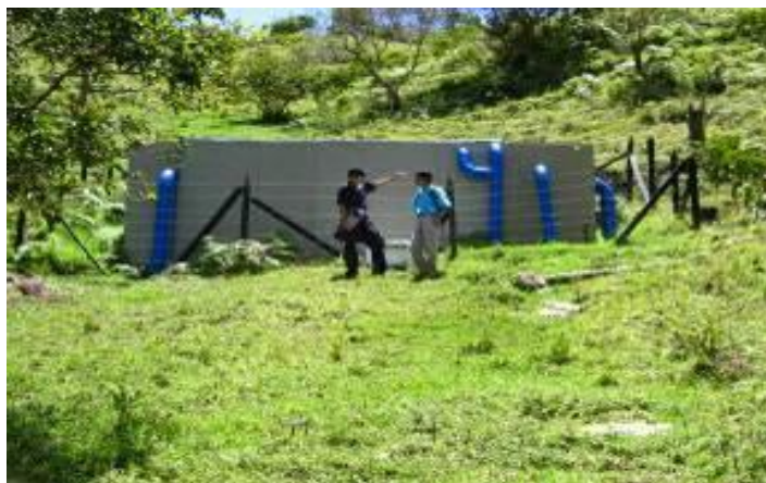
Fotografía 16. Desarenador acueducto de El Peñol
