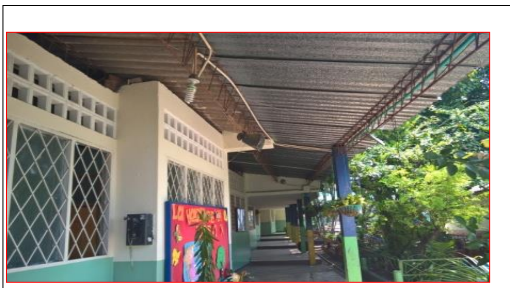
Foto 12. Cubierta en teja galvanizada en el corredor frente a la coordinación y preescolar de la edificación de la Institución Educativa Escuela Ciudad Jardín
