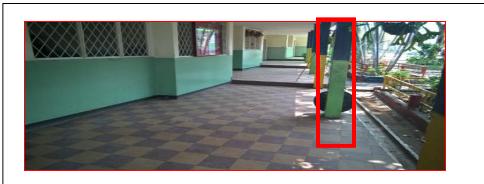
Foto 3. Columnas cuadradas exteriores construidas en la edificación de la Institución Educativa Escuela Ciudad Jardín
