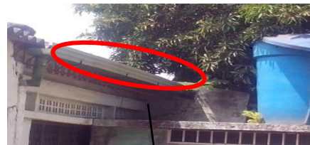
Foto 16. Canal en lámina galvanizada calibre 18 de forma rectangular existente para recoger las a-ll de la cubierta de la edificación Institución Educativa Escuela Ciudad Jardín
