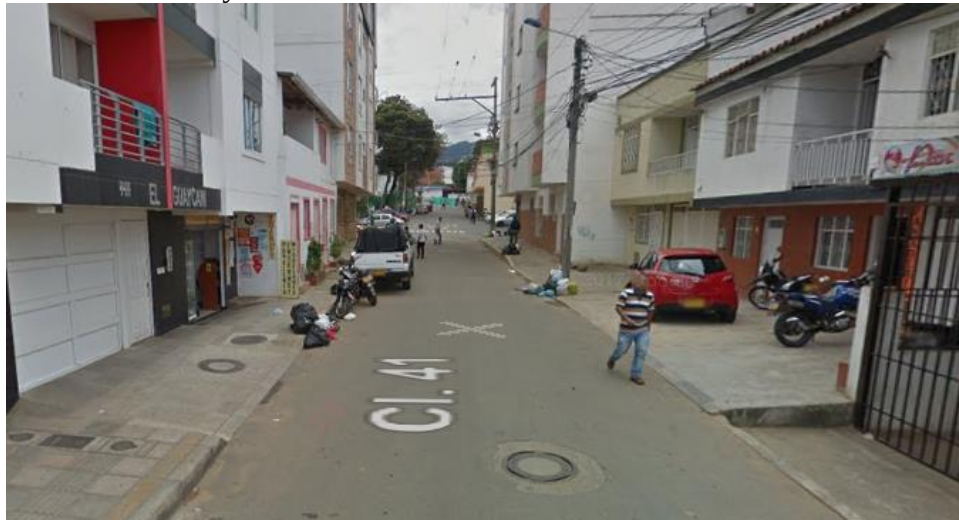
Figura 54. Estado de la vía y andenes de la calle 41
