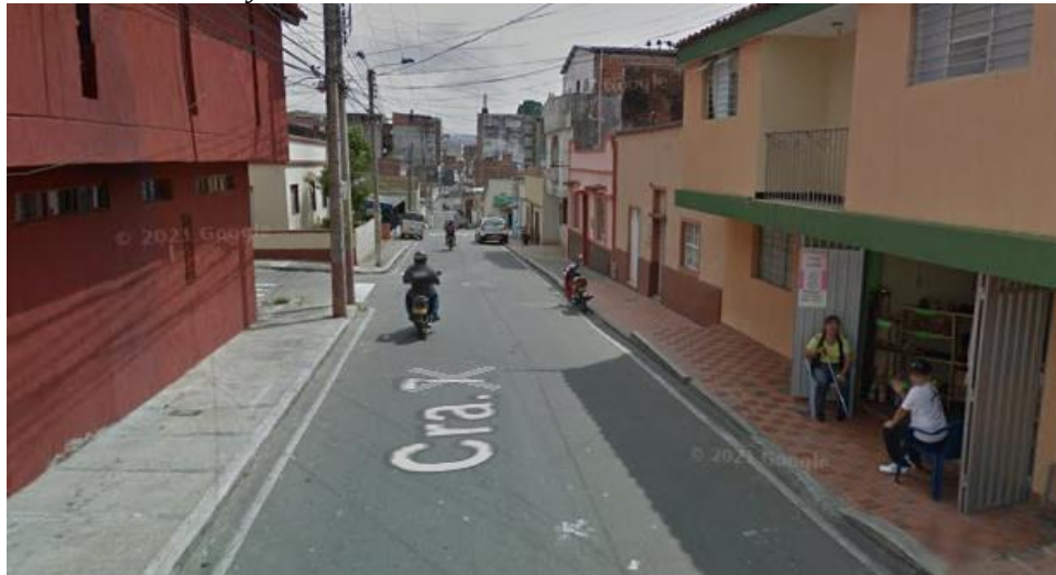
Figura 51. Estado de la vía y andenes de la carrera 7
