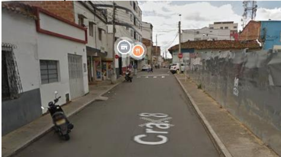
Figura 52. Estado de la vía y andenes de la carrera 8
