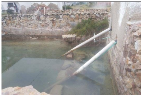
Imagen 1: Se muestra una sobreexplotación del recurso no renovable de aguas termales, con captación de este pozo en tubería de 6 pulgadas. Fuente Autores, 2017.
