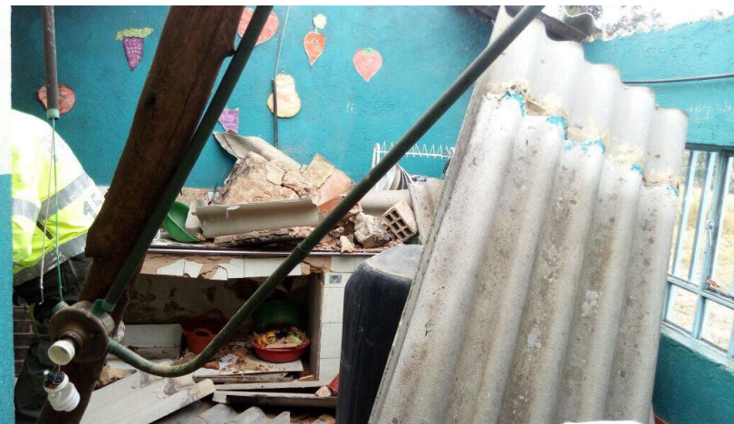
Ilustración 7 Vivienda en riesgo
