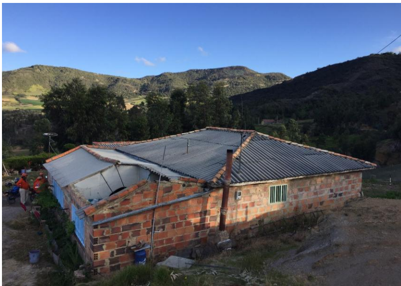
Ilustración 6 Vivienda en riesgo
