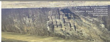
Fotografía N°1 sección de placa afectada
