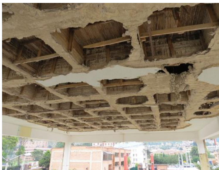
Fotografía 5 Casetones y tuberías inadecuadas, Fuente: propia
