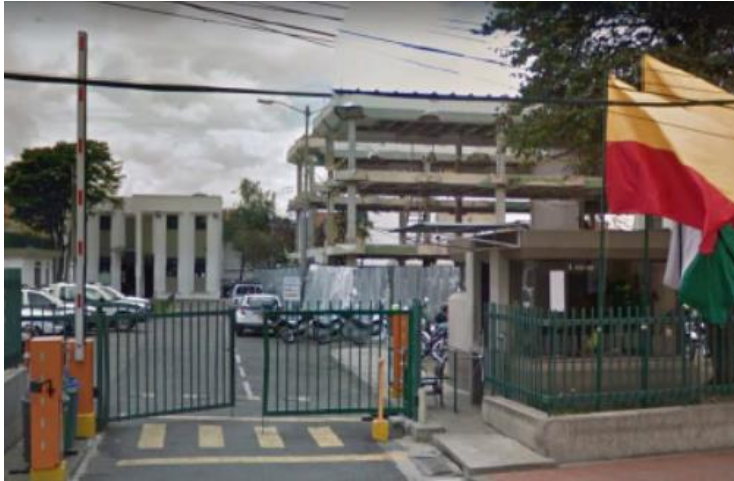
Fotografía 16. Edificación sin fachadas y acabados, Fuente: Policía Nacional de Colombia
