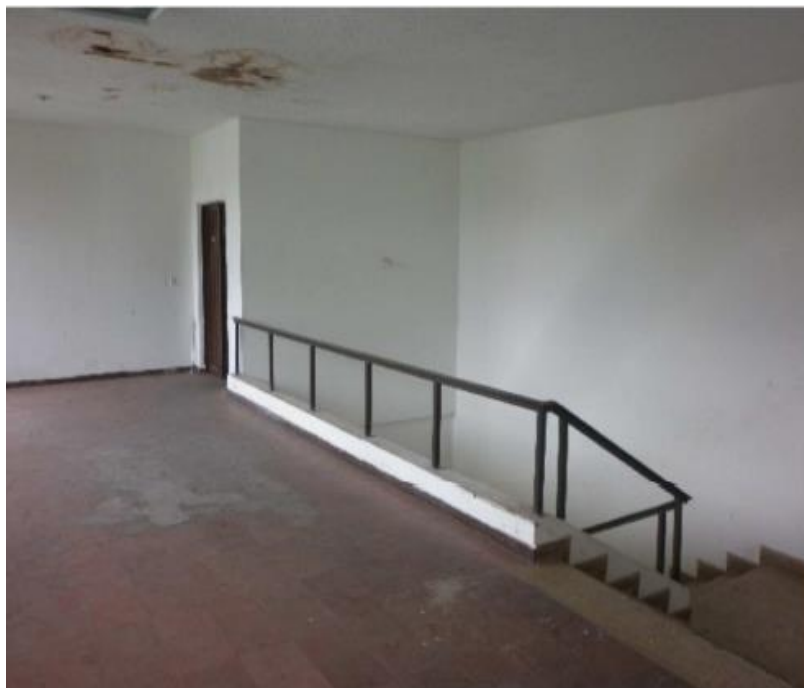
Fotografía 9. Humedades en cielo raso de piso 3, Fuente: Policía Nacional de Colombia
