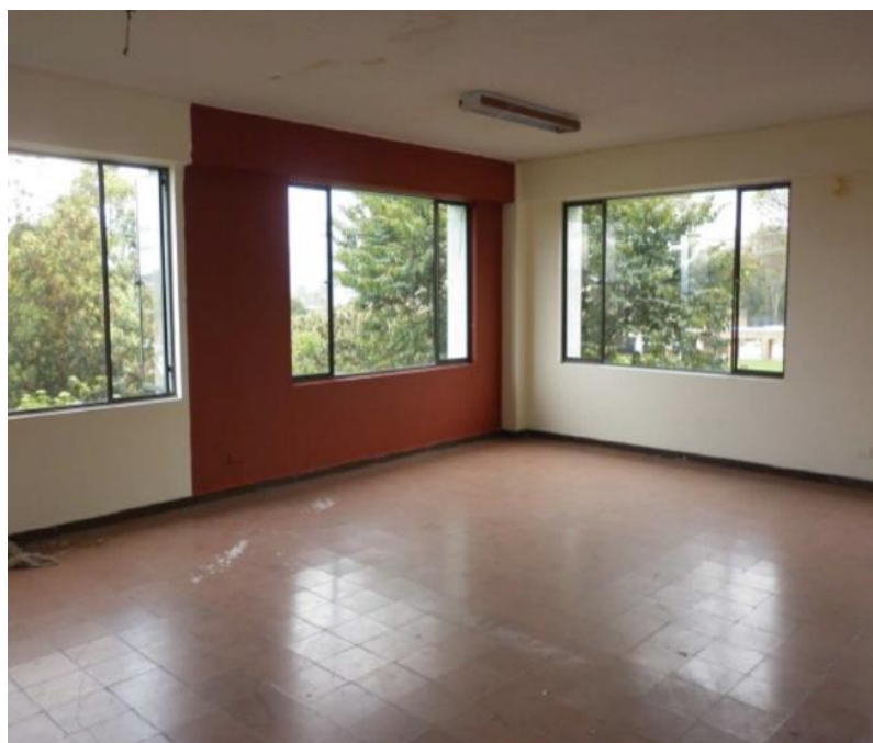
Fotografía 10. Humedades y fisuras en cielo raso de piso 3, Fuente: Policía Nacional de Colombia
