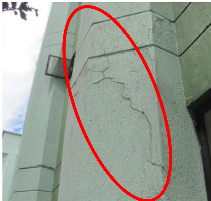
Fotografía 7. Grietas en fachada 2010, Fuente: Policía Nacional de Colombia
