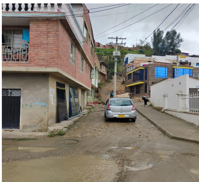
Figura- 3-Infraestructura vial deteriorada- Fuente: propia
