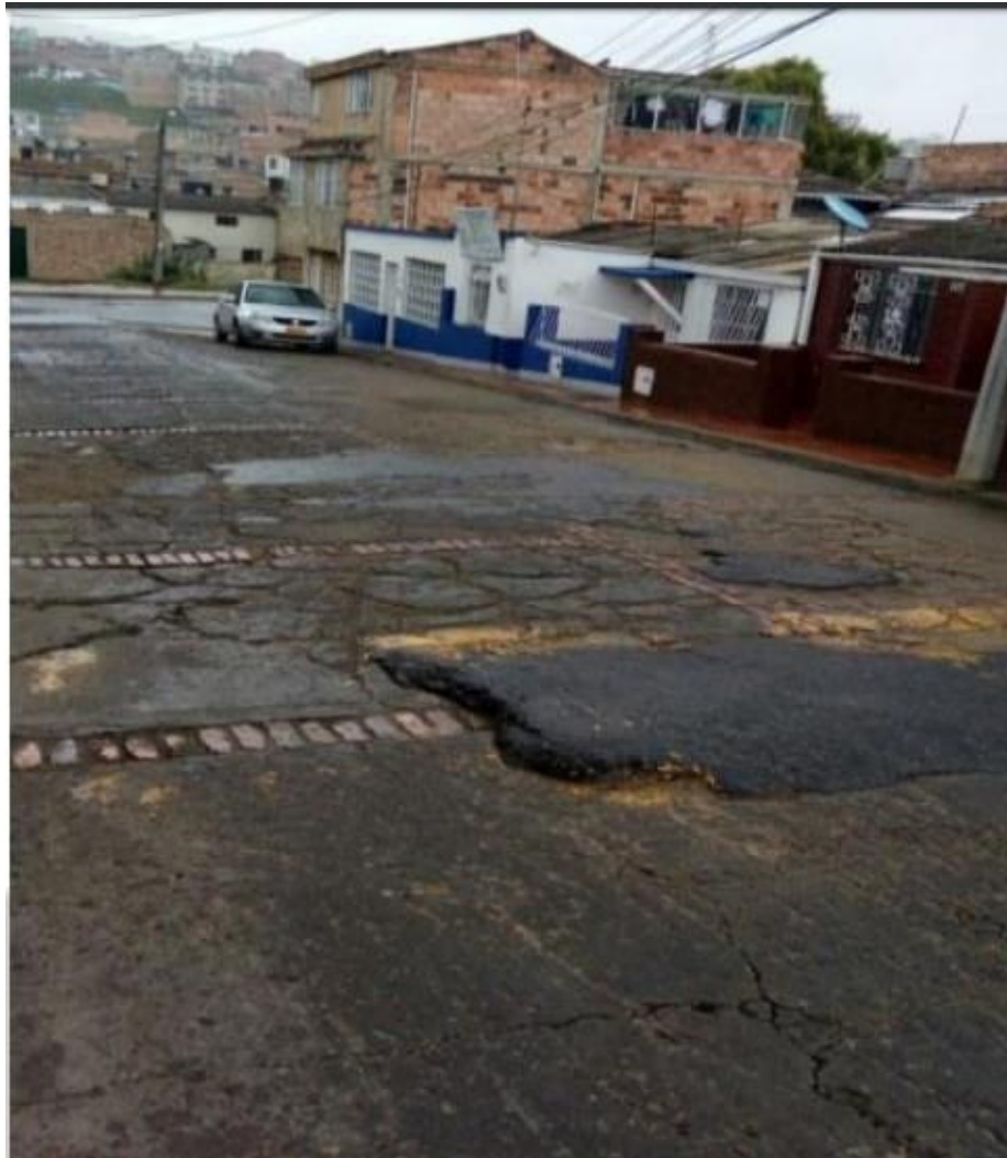
Figura 4. Estado de la vía.
