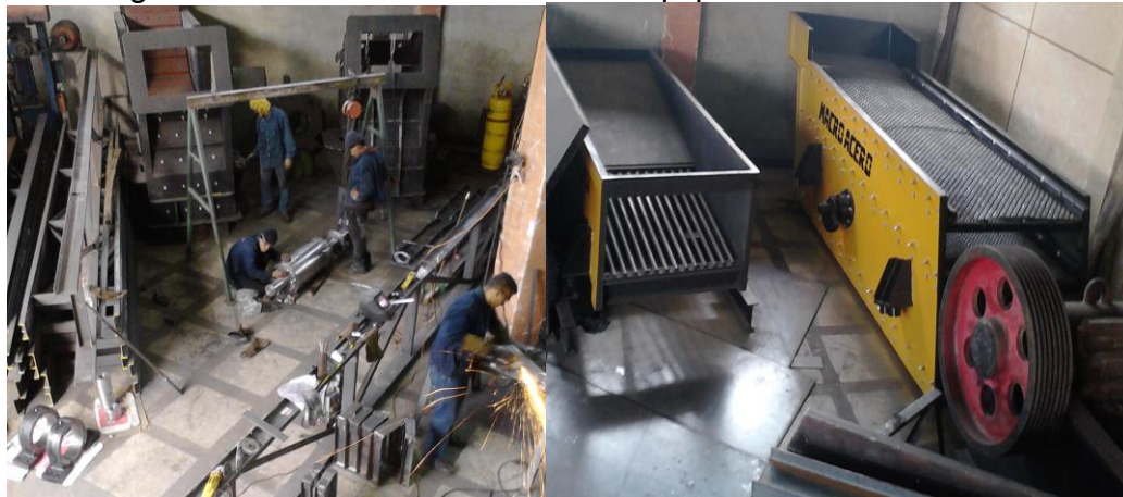
Figura 3. Planta de fabricación de equipos MacroAcero Ltda.
